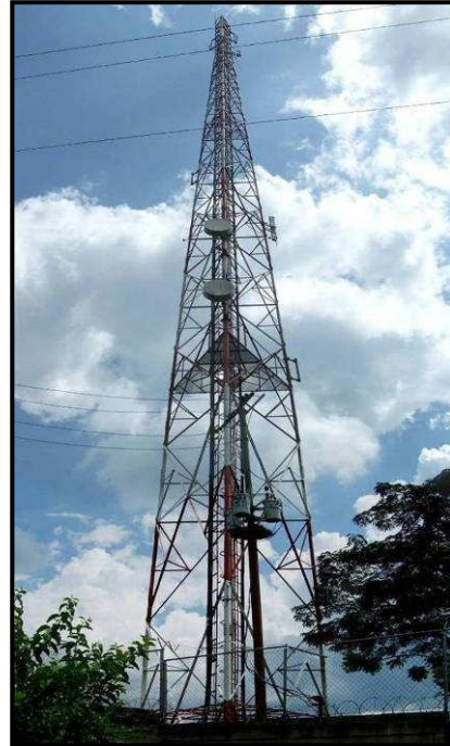
Figura 27. Torre Auto-soportada existente en la RBS 4
