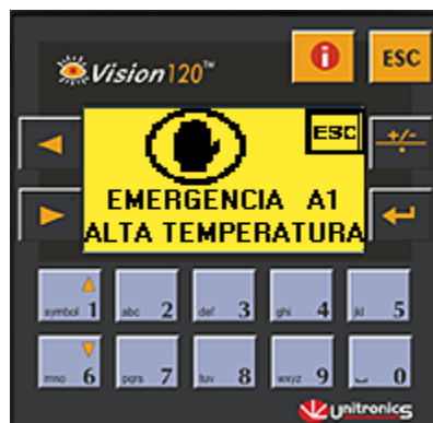
Figura 55. Pantalla de parada de emergencia (alta temperatura).
