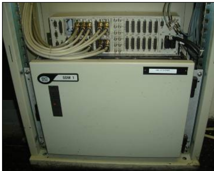
SDM 1 existente en la Estación
