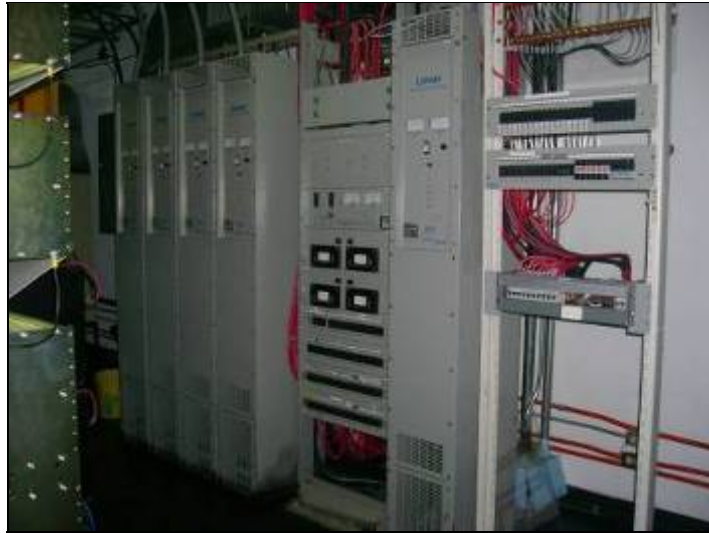
Sistema de Energía de la Estación
