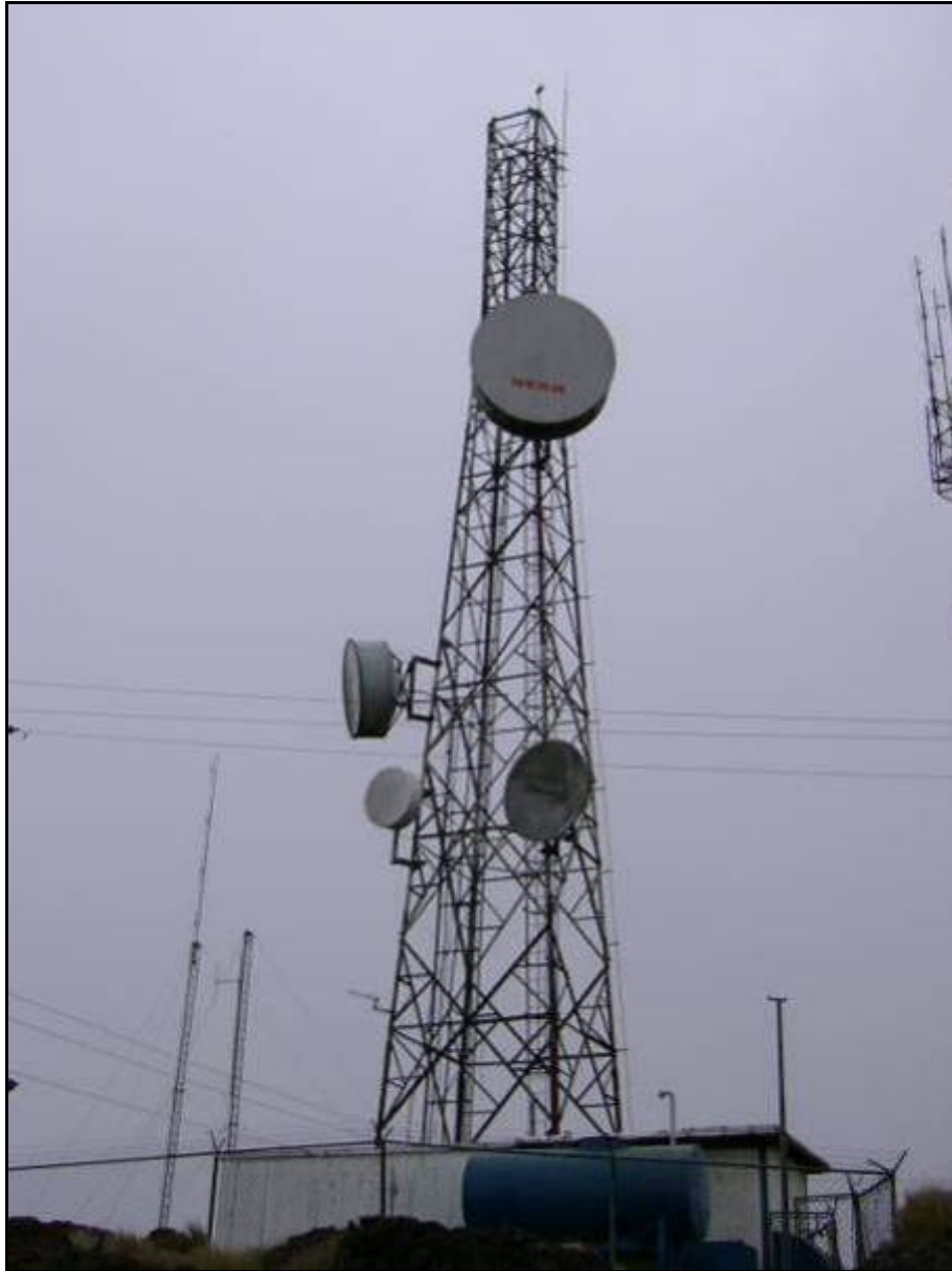
Vista de Torre a utilizar
