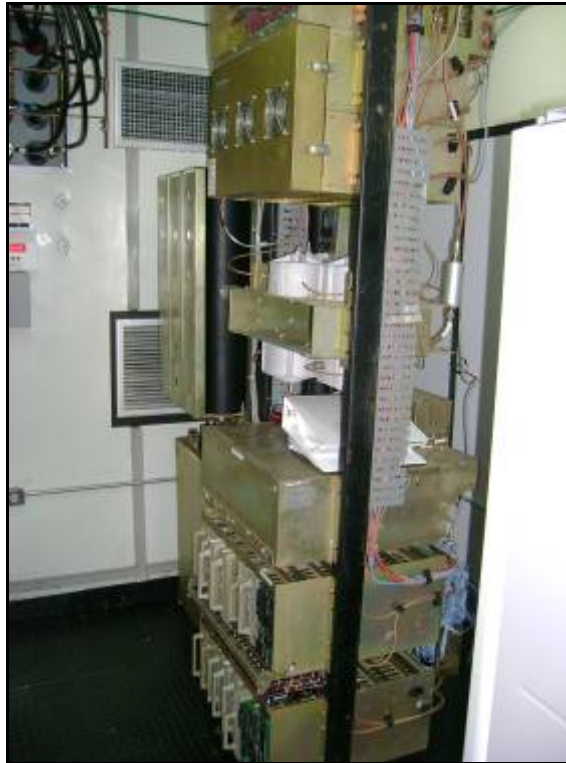
Bay a desincorporar (fuera de servicio). Lugar propuesto para la instalación de radio LSY dirección PISCURI.
