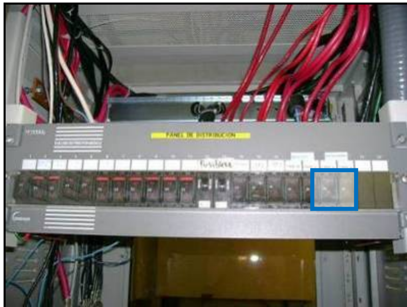
Panel de distribución de breakers y espacio propuesto para alimentar radio LSY.
