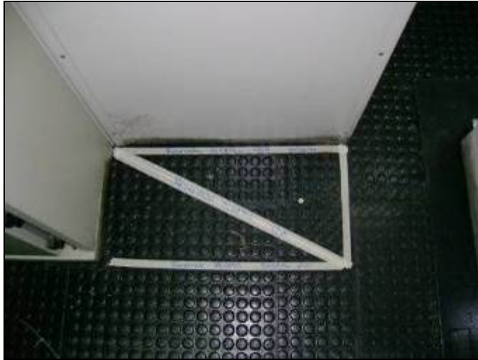
Espacio reservado para radio. El espacio se encuentra justo al lado del SDM 1 existente en la estación.
