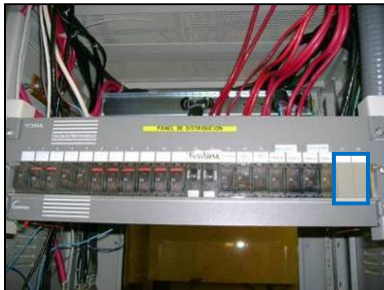
Panel de distribución de breakers y espacio propuesto para alimentar radio LSU.
