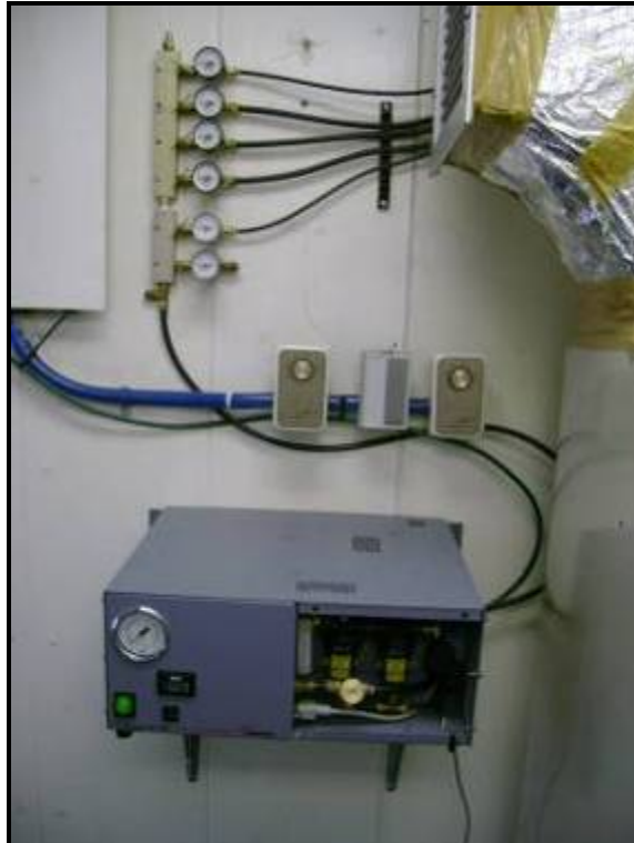
Presurizador ANDREW existente en la sala con una boquilla disponible.
