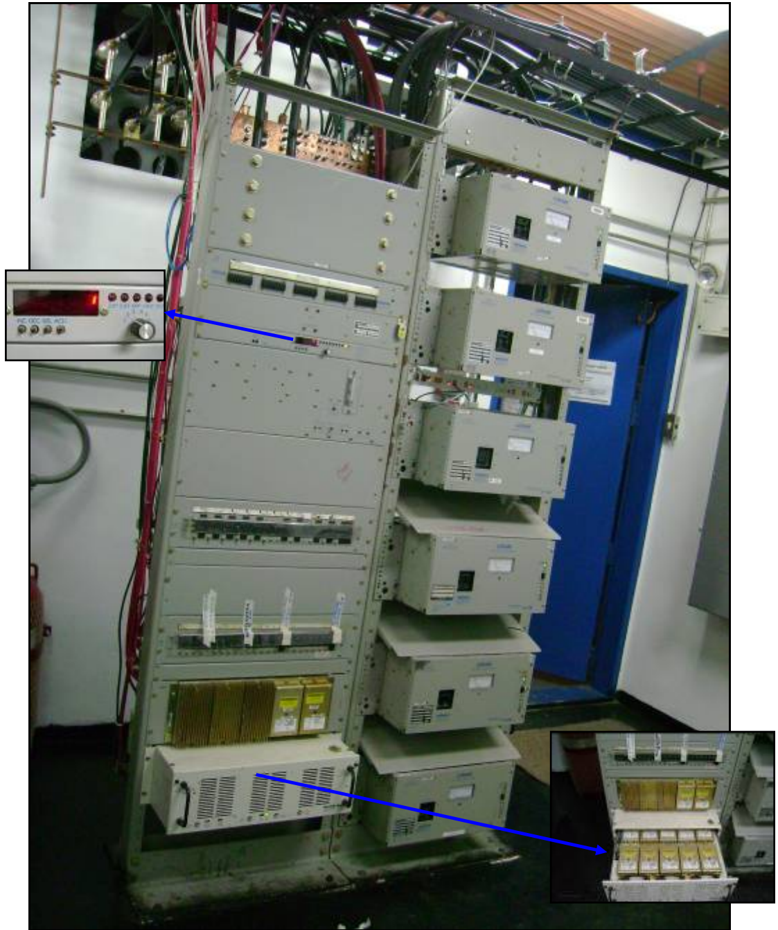
Vista general de PDB Lorain a utilizar, vista de display dañado y módulos @-48Vdc.
