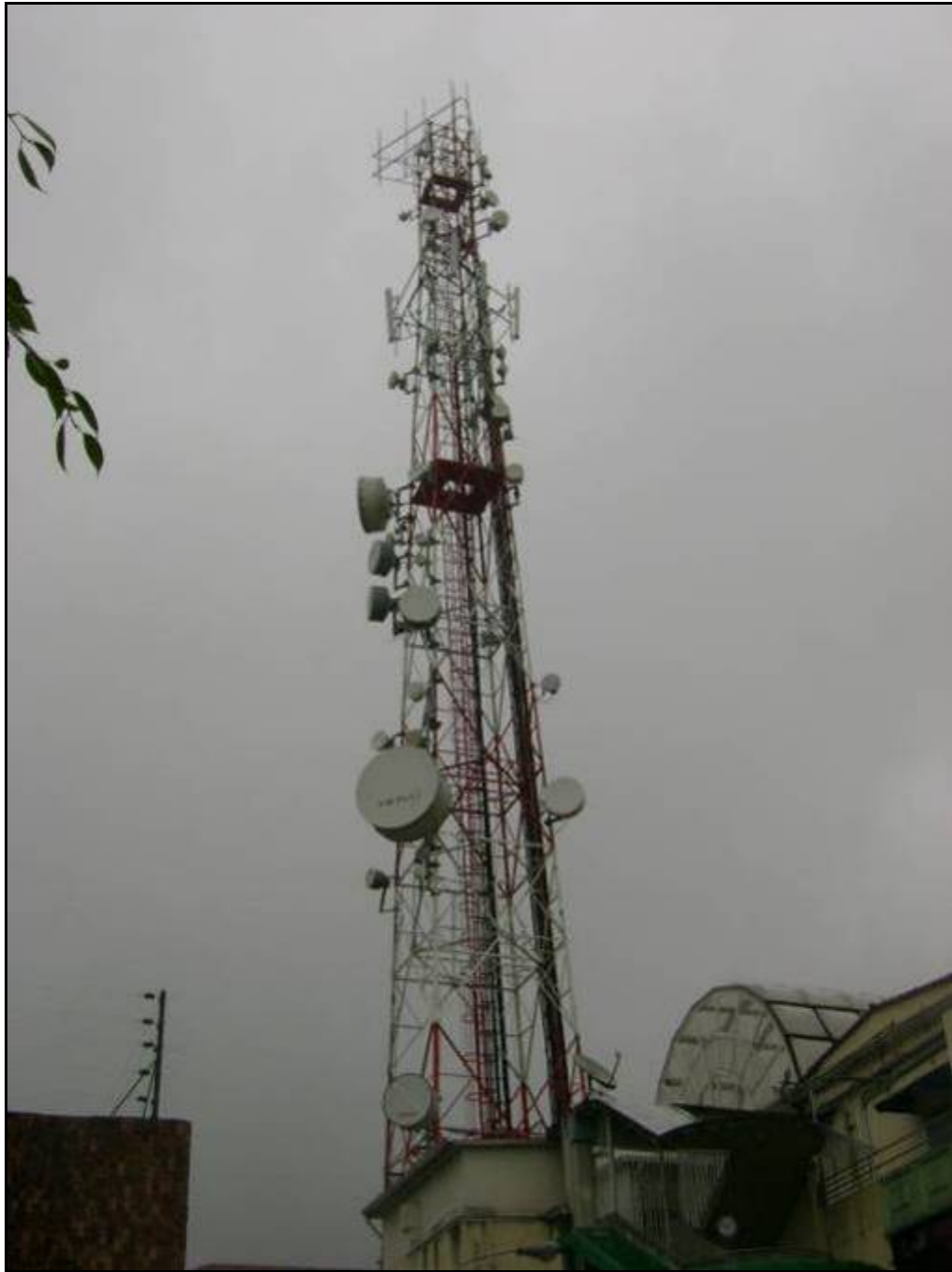
Vista de la Torre a Utilizar.
