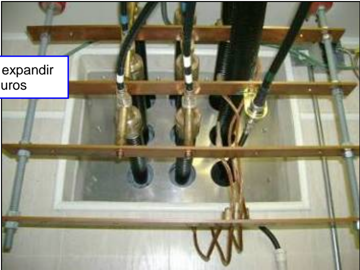
Vista interna de pasamuros que requiere expansión.
