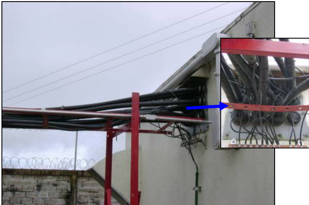
Vista exterior y Zoom de pasamuros sin disponibilidad. Se requiere una adecuación
