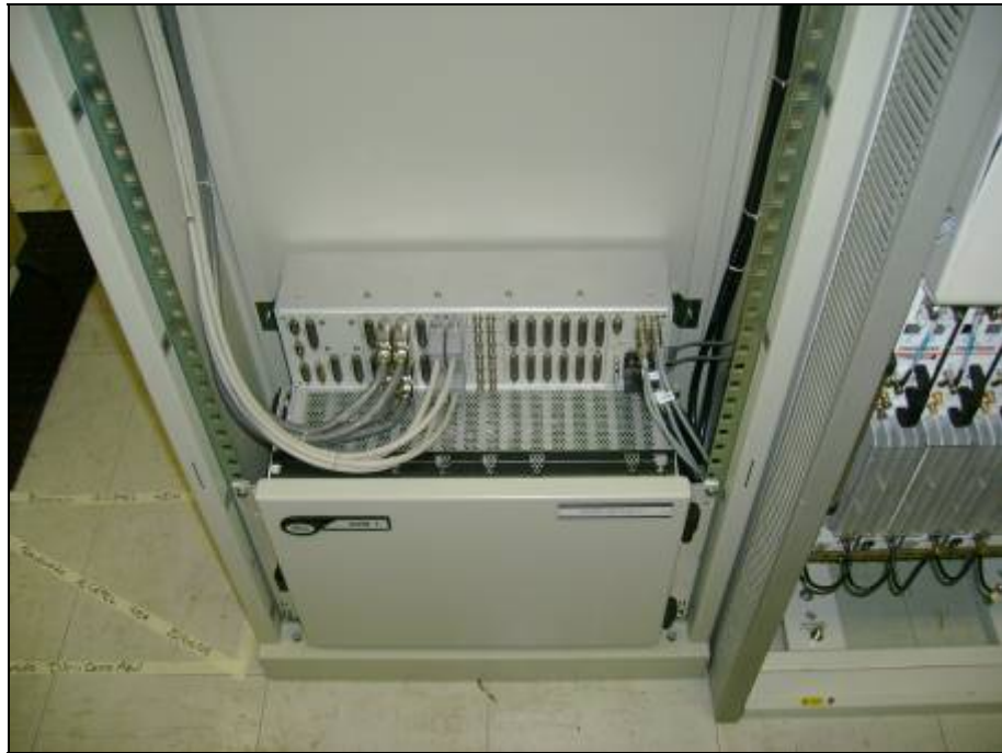
Vista de SDM - 1 existente en la sala
