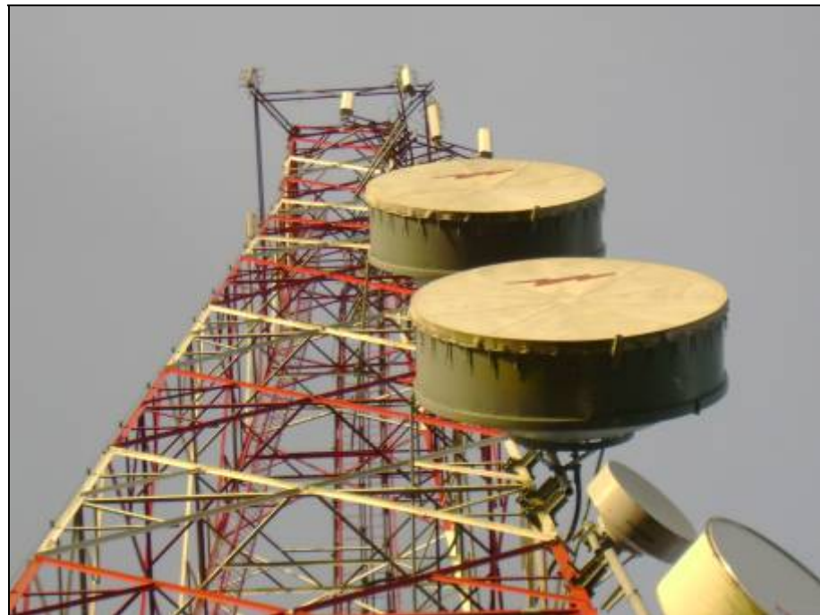
Vista de antenas existentes hacia Píscurí (Zoom)
