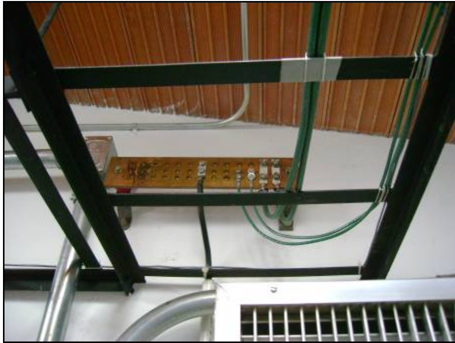
Barra MGB existente en la sala.
