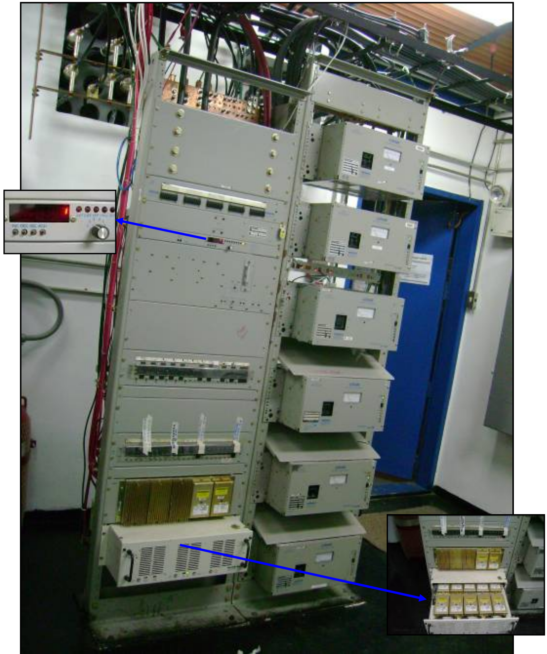
Vista general de PDB Lorain a utilizar, vista de display dañado y módulos @-48Vdc.
