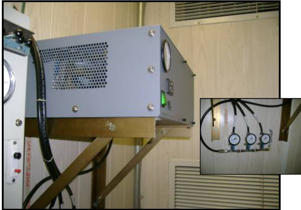
Vista de presurizador existente en la sala y zoom de boquillas. Se debe agregar nueva boquilla para la instalación.
