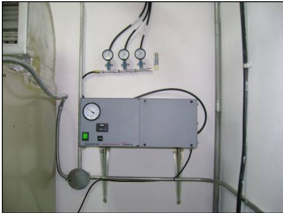
Presurizador existente en la sala. Se deben agregar 2 nuevas boquillas para la instalación.
