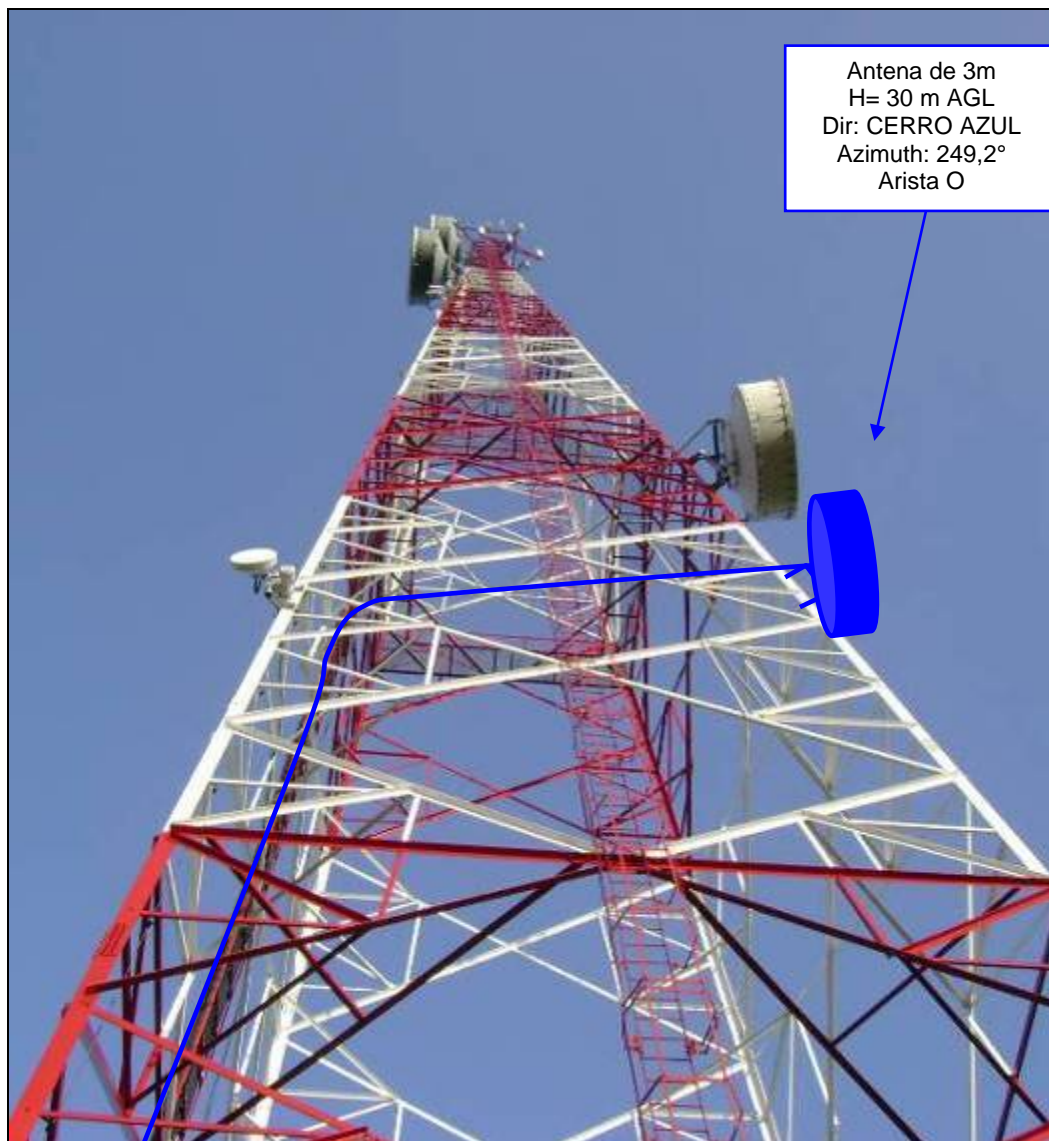
Vista de Torre a utilizar y posición sugerida para la antena.
