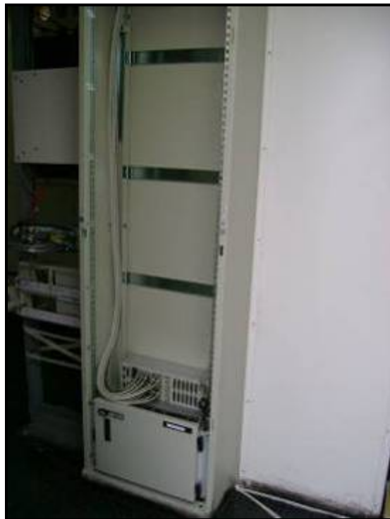
SDM 1 existente en la sala.
