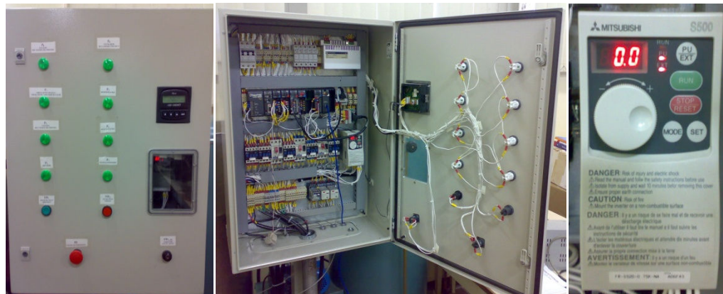
Figura 30. Vista Externa e interna del cajetín y Variador de Frecuencia en detalle.
