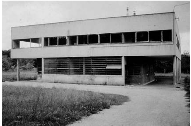
Esta obra ha sufrido importantes deterioros.
