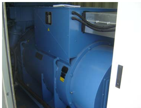
Ilustración 16. Generador marca Marelli
