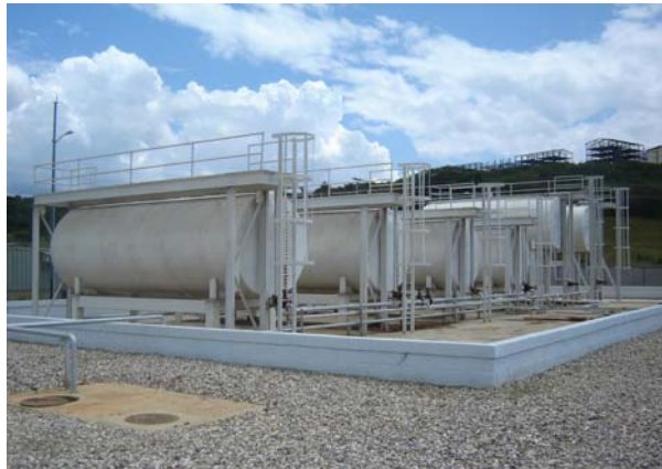
Ilustración 18. Tanques de almacenamiento y operación
