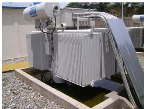
Ilustración 17. Transformador Elevador 480/13.800 V
