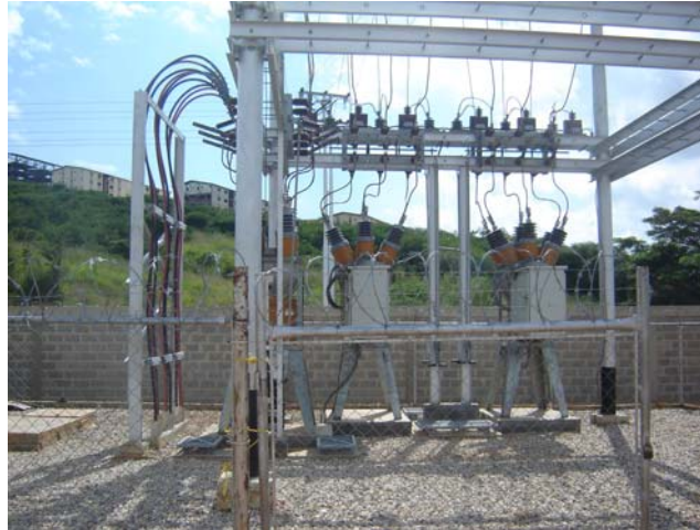
Ilustración 14. Pórtico de Salida del Emplazamiento a la Subestación
