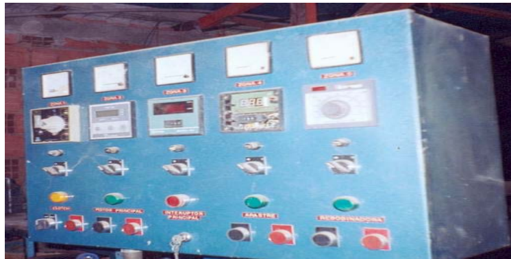
Figura 71: controlador de temperatura por resistencias y ventilación
