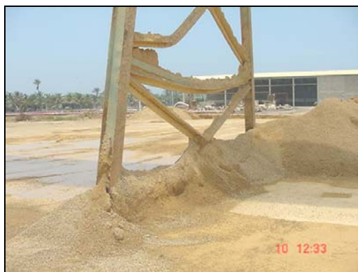
Figura A.14 Estado de la cercha.
