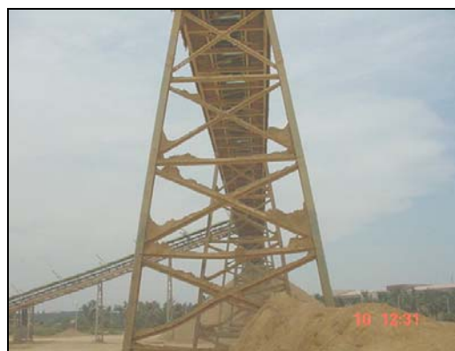
Figura A.13 Acumulación de RF sobre cercha.
