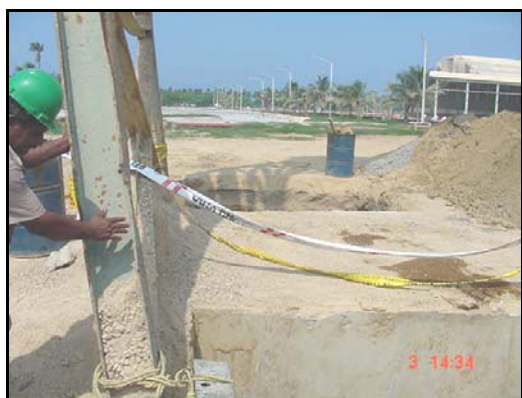
Figura A.35 Montaje de sistema de seguridad.
