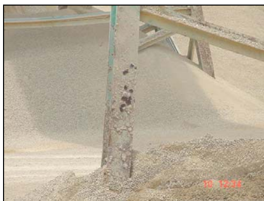
Figura A.16 Corrosión sobre CB-5 (1).
