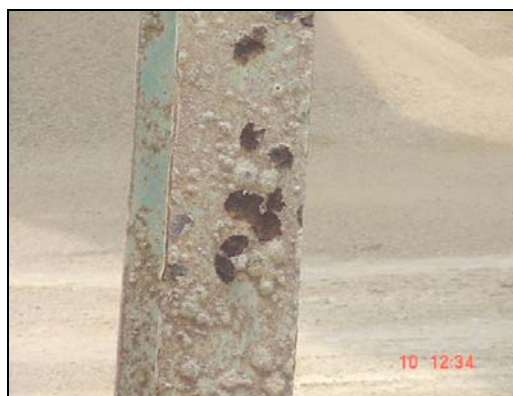
Figura A.17 Corrosión sobre CB-5 (2).
