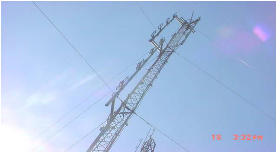
Imagen 3.4 Antenas para el Sistema Barlovento
