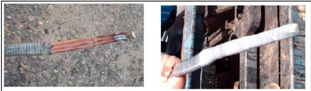
Figura 2. 10: Corto-circuito con cable BES.
