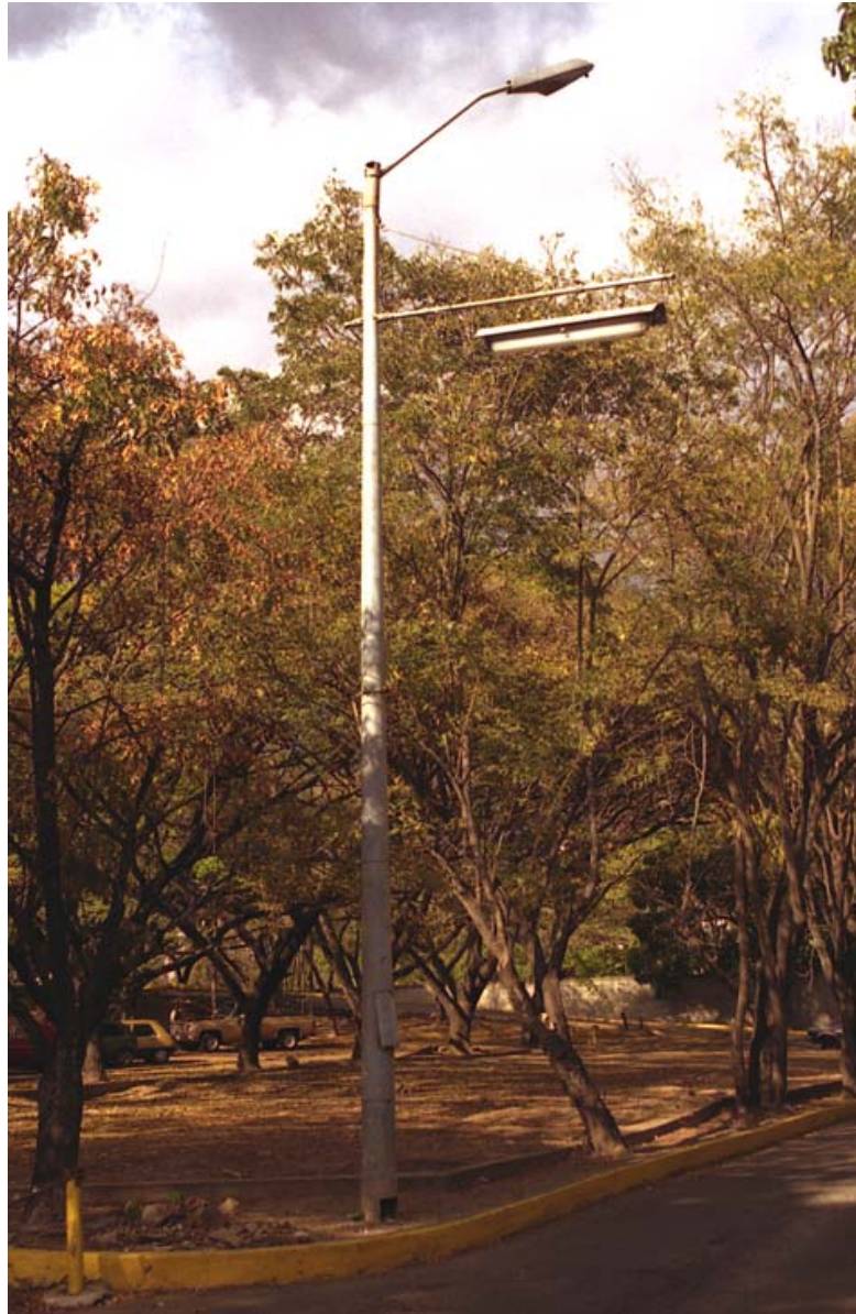
Esta Luminaria es del tipo simple modificada y está ubicada en la Calle sin nombre (Calle Las Banderas).
