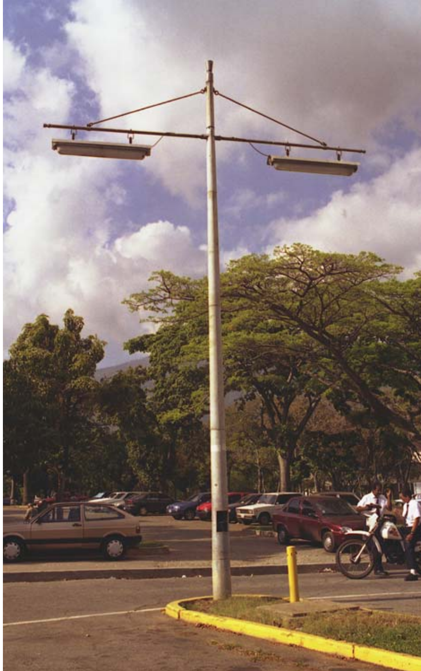
Esta Luminaria es original doble y muestra la ausencia de la Boca de Visita en el Poste.
