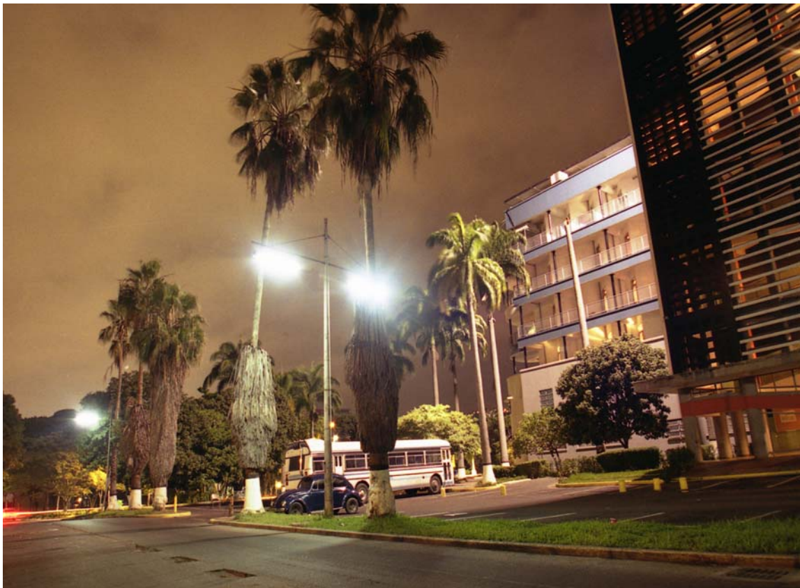
Esta Luminaria es original doble y muestra la intensidad de luz que emite. Está ubicada en la Avenida Hospital.
