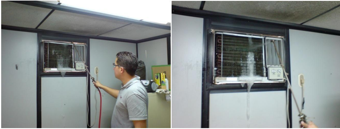
Figura N°4.26 Mantenimiento del evaporador. (Fuente: Referencia N°1)
