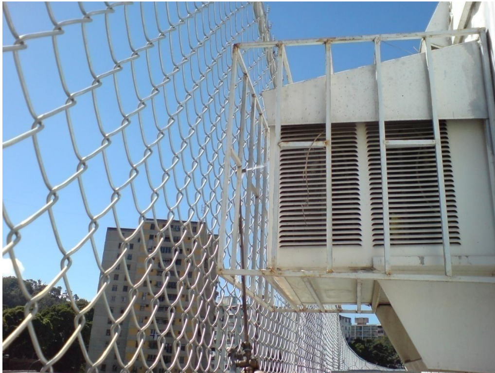
Figura N°4.31 Trabajo de mantenimiento en un serpentín de condensación de difícil acceso. (Fuente: Referencia N°1 )
