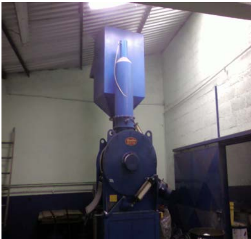
Figura 6.7 Vista 1 Mezcladora Nueva
