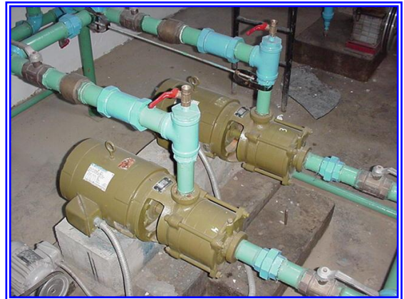
Fig. II.9. Bombas de Agua
