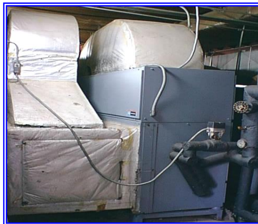
Figura II.3. Unidad Manejadora de Aire (UMA) de Confort
