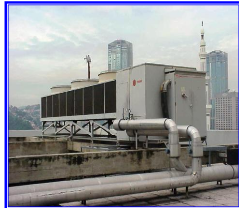
Figura II.2. Chiller enfriado por aire
