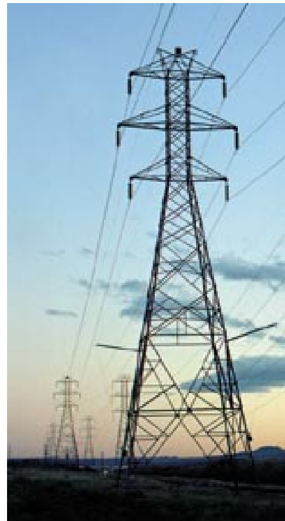
Foto 1 Torre tipo Celosía
