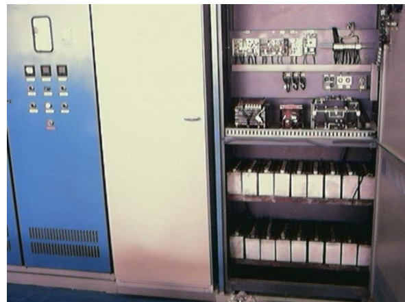
Ilustración 16 Banco de Baterías de la Estación 33
