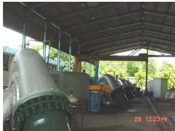
Ilustración 6 Patio de Bombas E/B 31
