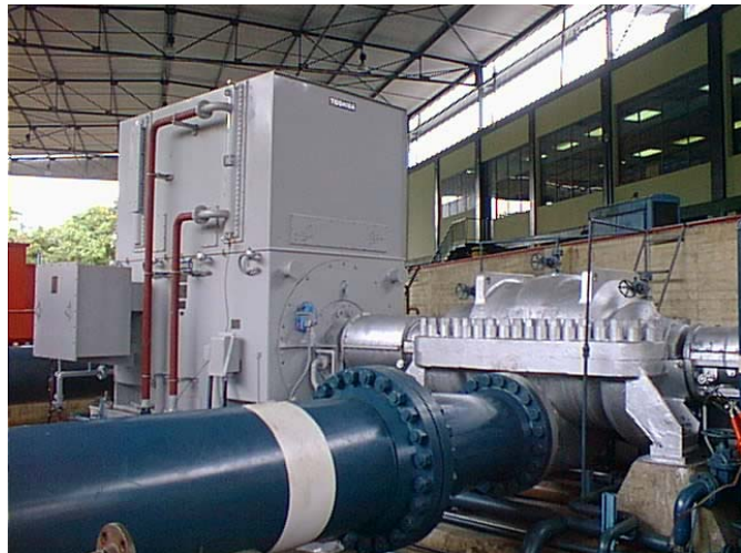
Ilustración 15 Motor de Corriente Alterna de la Estación 32
