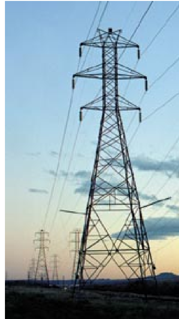
Foto 1 Torre tipo Celosía
