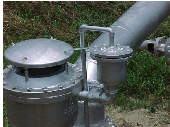
Ilustración 21 Válvula de Admisión y Expulsión de Aire, Punto de Entrega Uveritas
