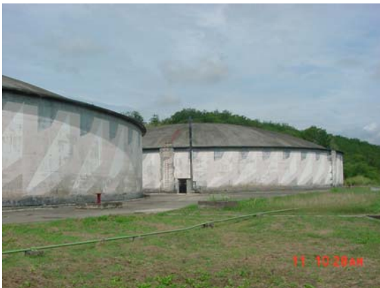
Ilustración 8 Tanques de Almacenamiento de Agua Tratada
