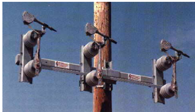
Ilustración 13 Seccionador de Corriente Fuente: www.vazparfotos.tripod.com
