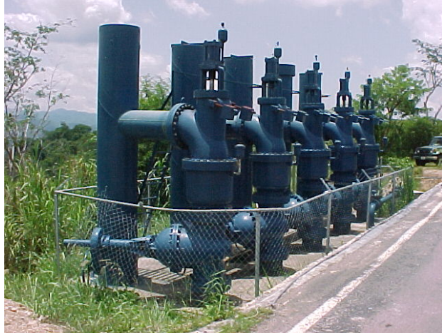
Ilustración 22 Válvulas de Chorro en la Tubería de 100' pulg.
