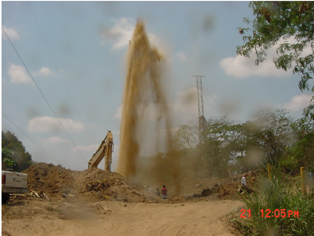
Foto 3 Fuga en Piloncito
