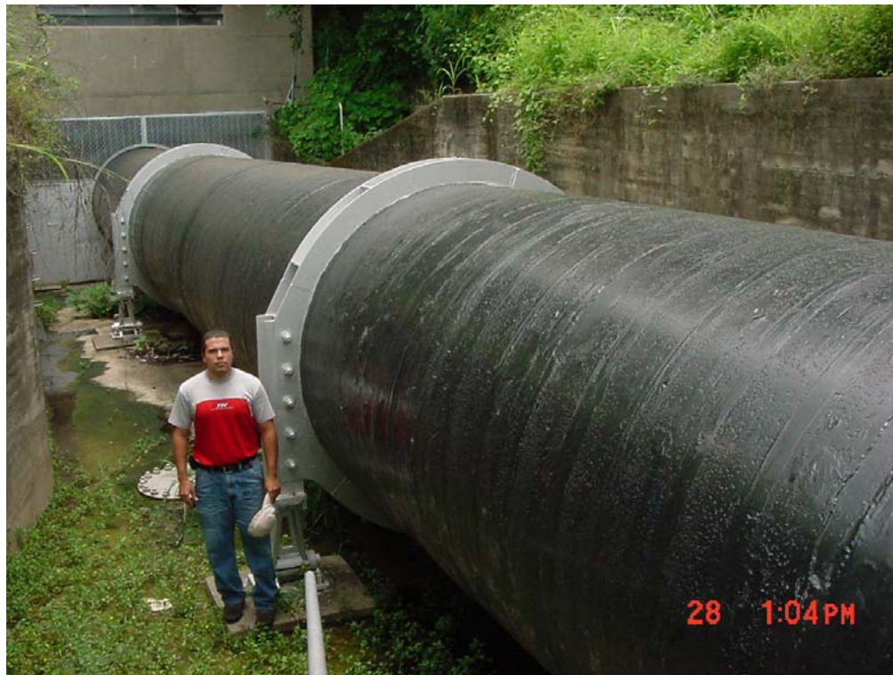
Foto 2 Tubería de Camatagua (D: 85 pulg)
