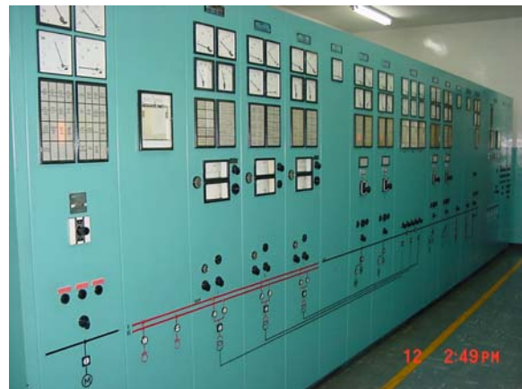
Ilustración 23 Sala de Mando E/B 31
