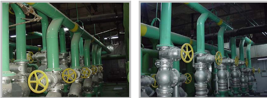
Fig. 4.14. Tubería de Agua de Condensación, múltiple de Succión y Descarga.
