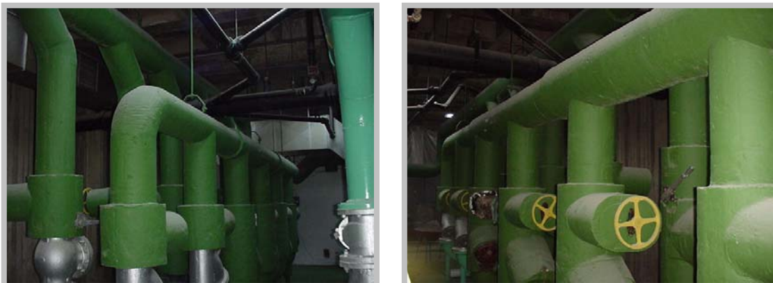
Fig. 4.11. Tubería de Agua Helada, múltiple de Succión y Descarga.
