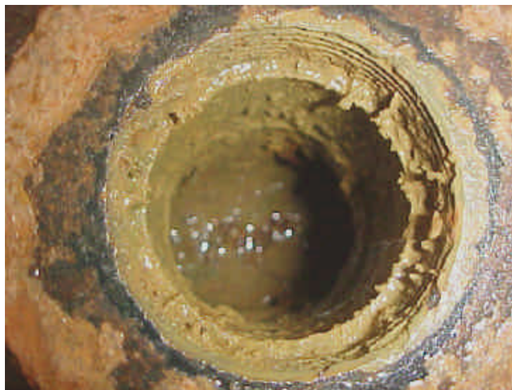
Figura 4.8 Barro presente en la entrada de alimentación. ( f_N = 2'' )
