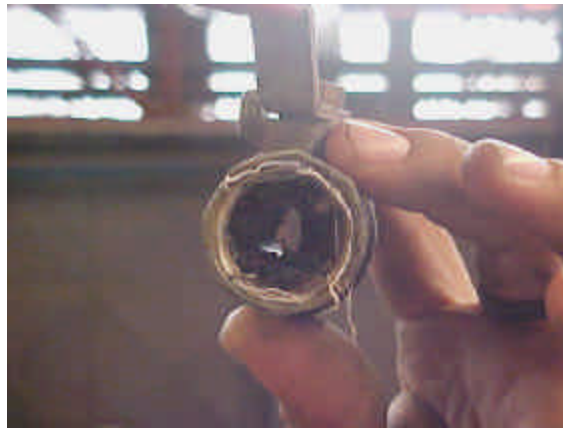
Figura 4.12 Obstrucciones en una llave de paso. ( f_N = 1^{1/2} " )
