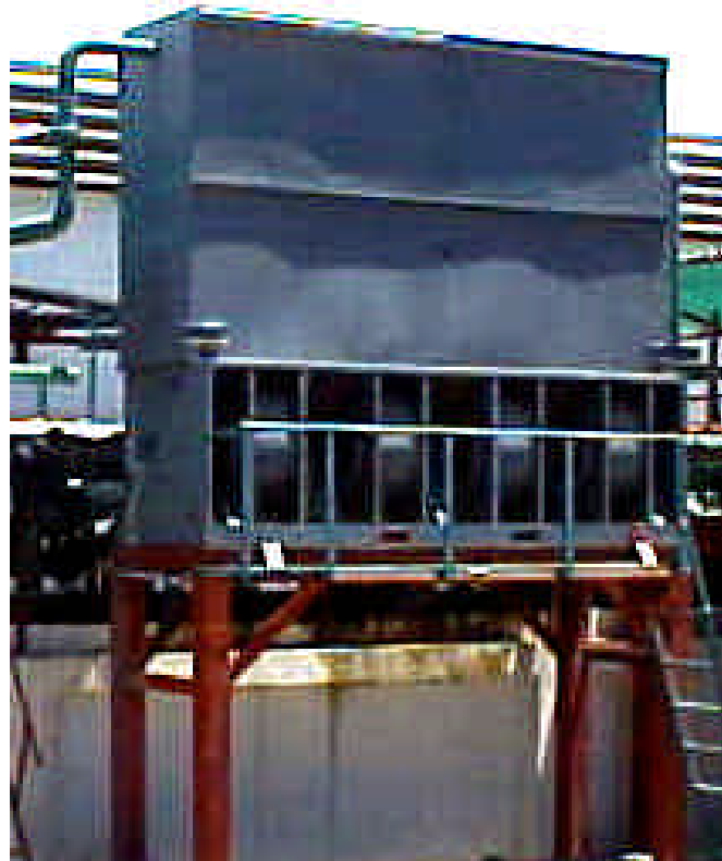
Figura3.10 Torre de enfriamiento W68-00
