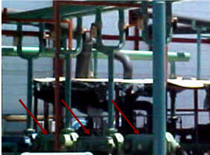
Figura 3.12 Bombas a – b - c del sistema de enfriamiento actual
