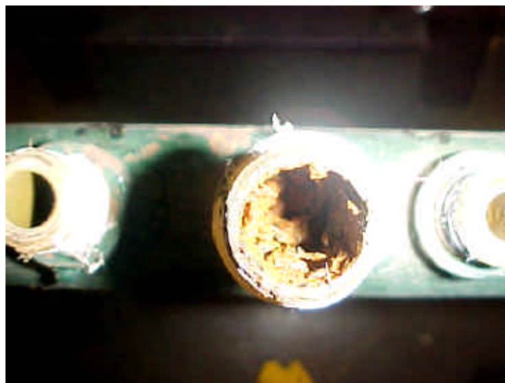
Fig. 4.9 Incrustaciones en las conexiones de distribución. ( f_N = 1^{1/2}'' )
