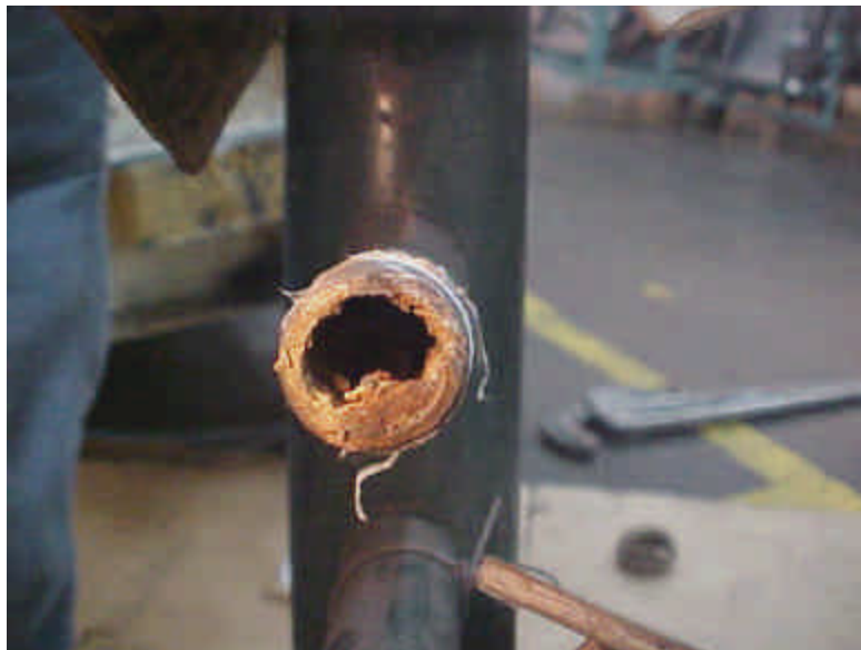
Fig. 4.11 Incrustaciones en las conexiones de distribución. ( f_N = 1^{1/2}'' )
