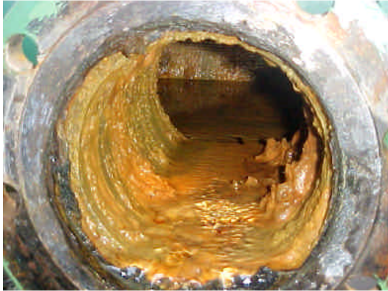
Figura 4.3 Incrustaciones en Tubería de Distribución. ( \varnothing_N = 6'' )
