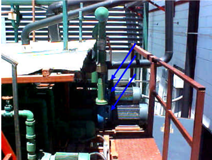
Figura 3.13 Bombas d – e - f del sistema de enfriamiento actual
