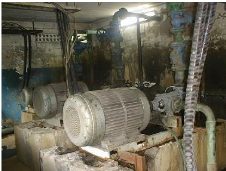
Ilustración 4.3 Detalle del deterioro de las bases de los grupos
