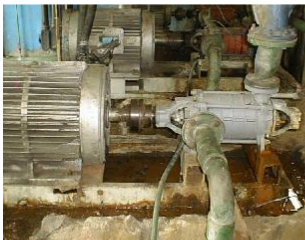
Ilustración 4.4 Detalle del deterioro de las bases metálicas
