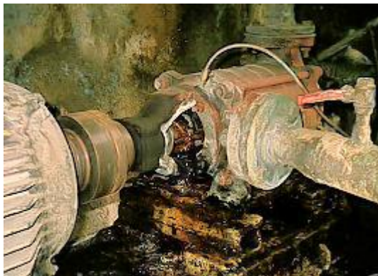
Ilustración 4.2 Detalle de la carcasa deteriorada de una de las bombas
