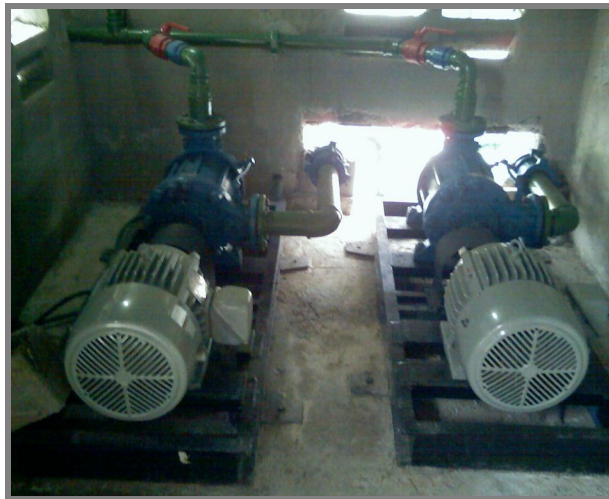
Fig. 24 Grupo de Bombeo en paralelo con sus respectivas válvulas
