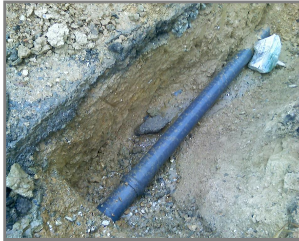
Fig. 26 Tubería instalada actualmente
