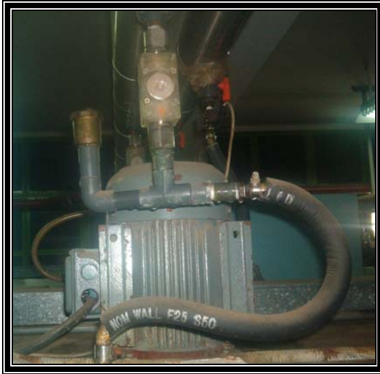
Fig. 4.1.-Motor Eléctrico (sobre el horno)
