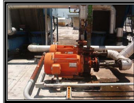
Fig.4.13-.Bombas de entrada al tanque
