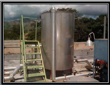
Fig.4.14-.Tanque de almacenamiento de agua
