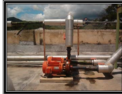
Fig. 4.15-.Bombas de salida de agua
