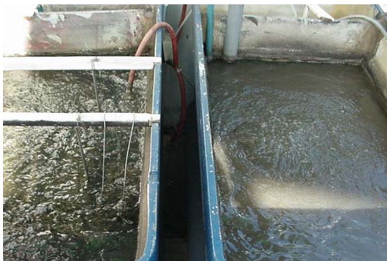
FIGURA 57. Imagen de los tanques a la semana de operación de la primera etapa
