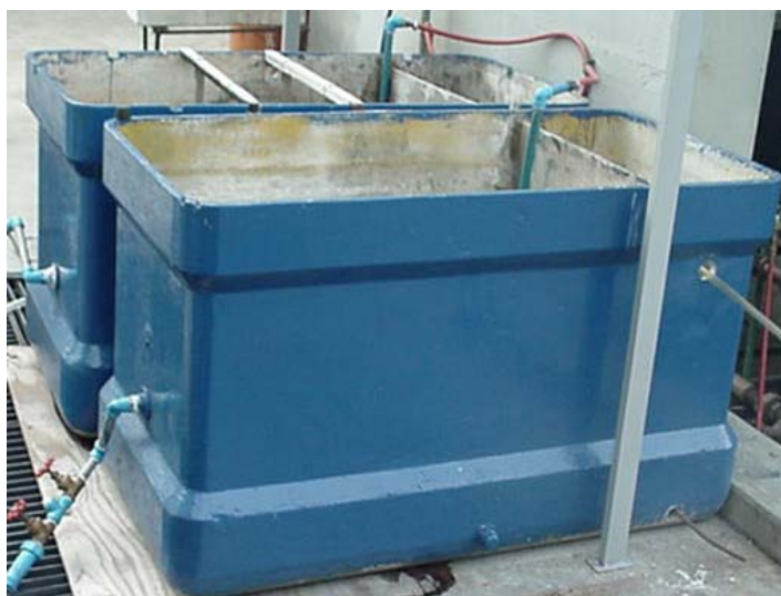
Figura 14: Vista lateral de los dos tanques. Atrás Sistema Híbrido. Primer plano: Sistema de lodos Activados.
