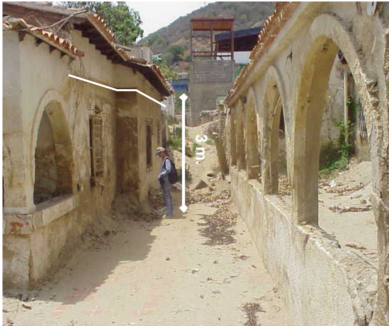
Figura 31. Marcas de barro de la inundación en una casa ubicada al Oeste de la canalización principal, 10 m al Sur del punto 36. Rumbo de la foto E-W.
