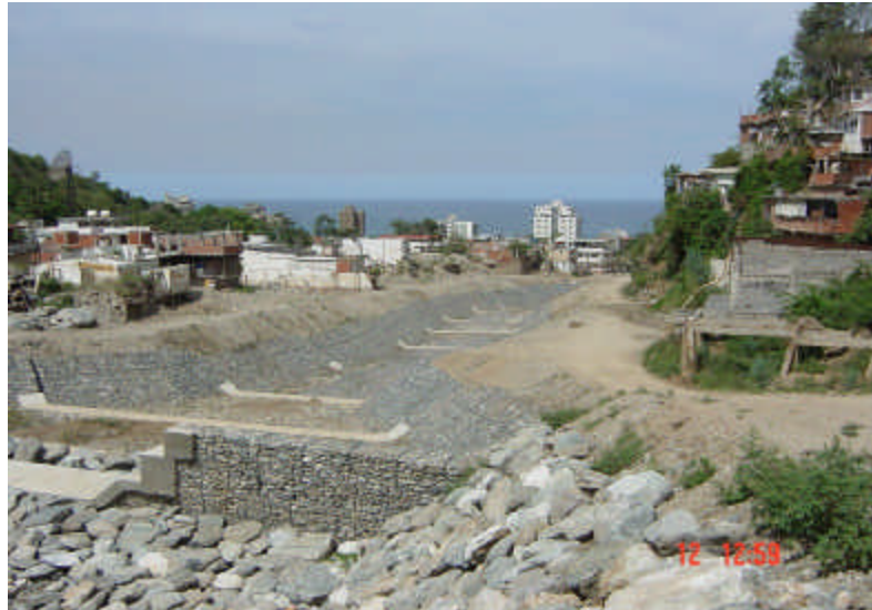
Figura 93. Represa de retención de sedimentos, ubicada cercana a la salida de la zona Montesuma. (Rumbo de la foto N15°W).
