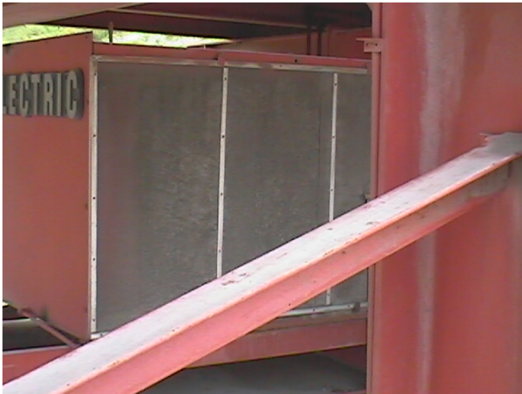
Figura 6.14, Polvo de cemento depositado en la unidad (Planta Guanta-Guanta)
