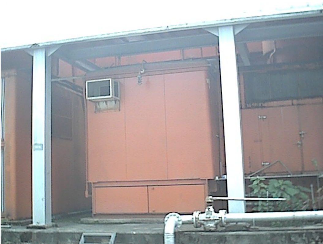
Figura 5.13, Falta del sistema de aire acondicionado
