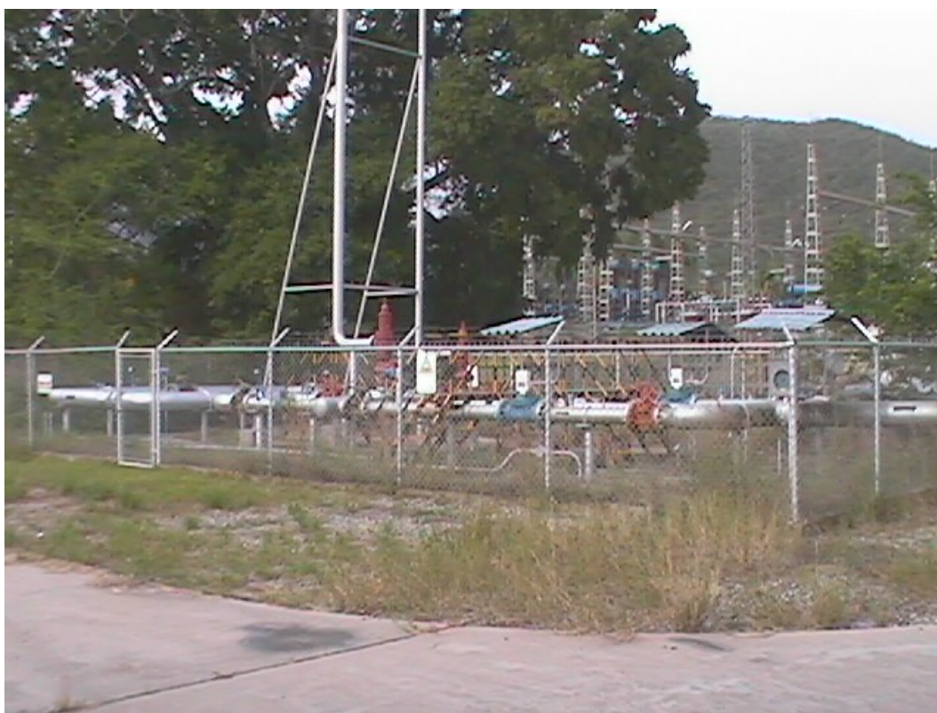
Figura 6.13, Estación de gas (Planta Guanta-Guanta)
