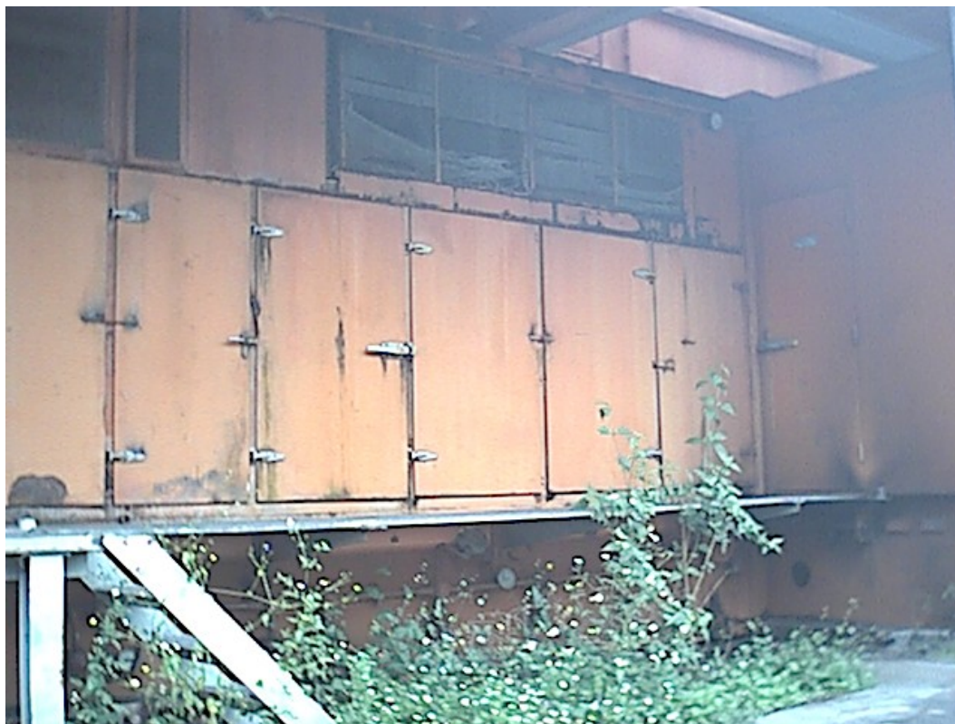
Figura 5.14, Deterioro por abandono de la unidad
