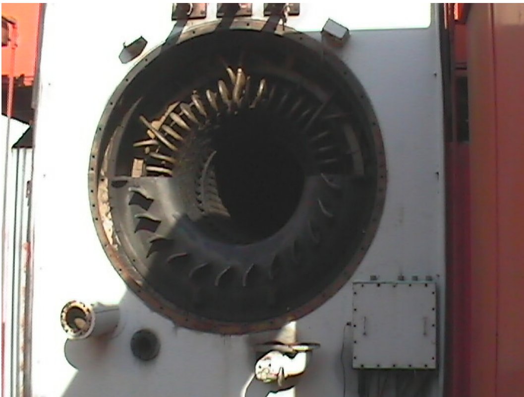
Figura 5.6, Falta rotor de la turbina, se observa el mal estado del bobinado del estator
