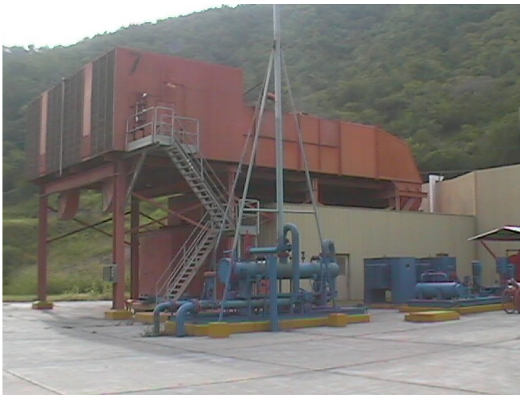
Figura 6.11, Unidad MS-7001E ubicada en planta Guanta
