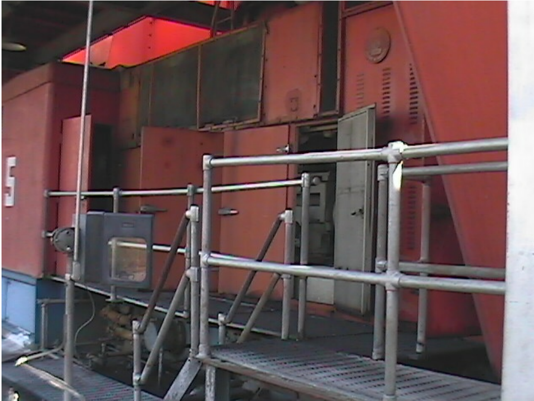
Figura 5.9, Aspecto exterior de la unidad turbogas
