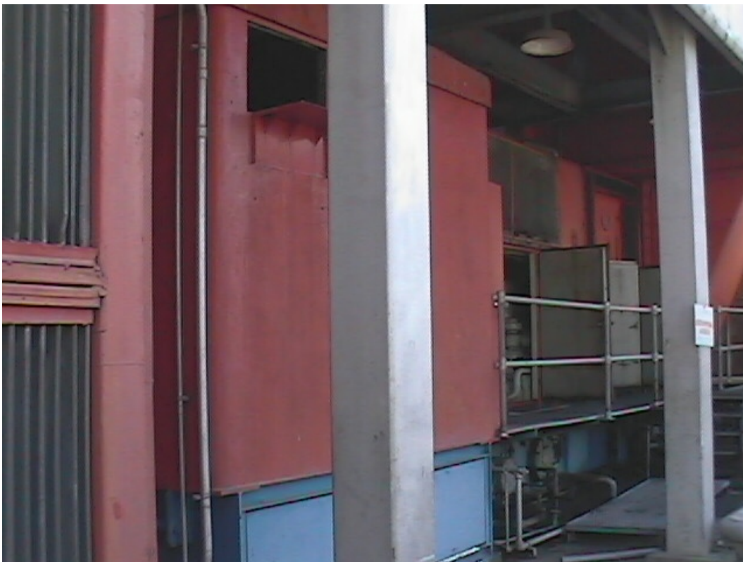
Figura 5.10, Aspecto exterior de la unidad turbogas
