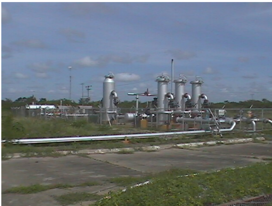
Figura 6.5, Estación de gas de la planta (Planta Alfredo Salazar-Anaco)
