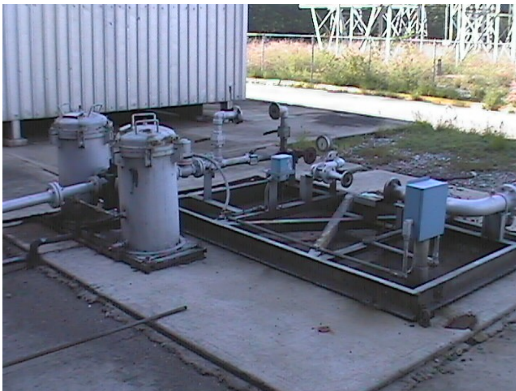
Figura 5.2, Faltan piezas del skid de combustible
