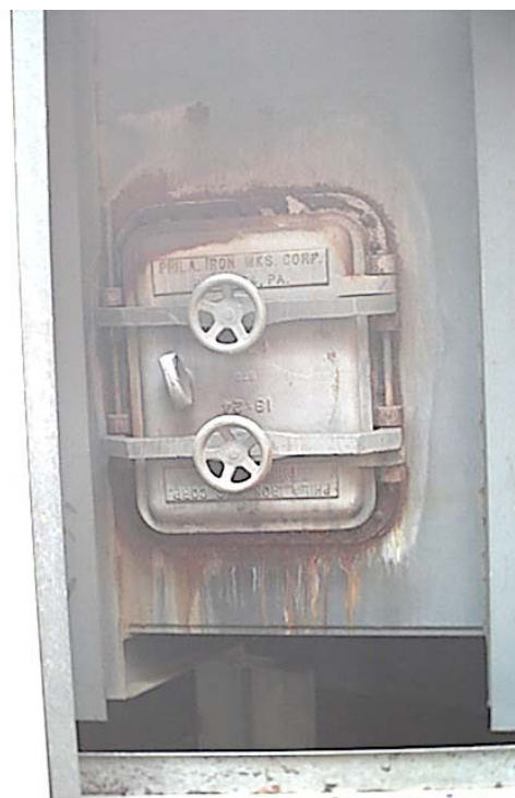
Figura 5.16, Oxidación de la puerta de inspección de la chimenea
