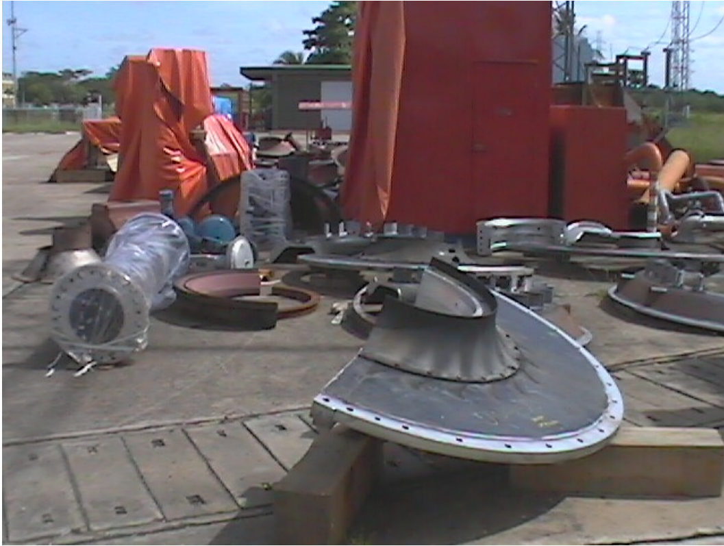
Figura 6.2, Partes y piezas a ser utilizadas en el mantenimiento mayor de una unidad MS-7001E (Planta Alfredo Salazar-Anaco)
