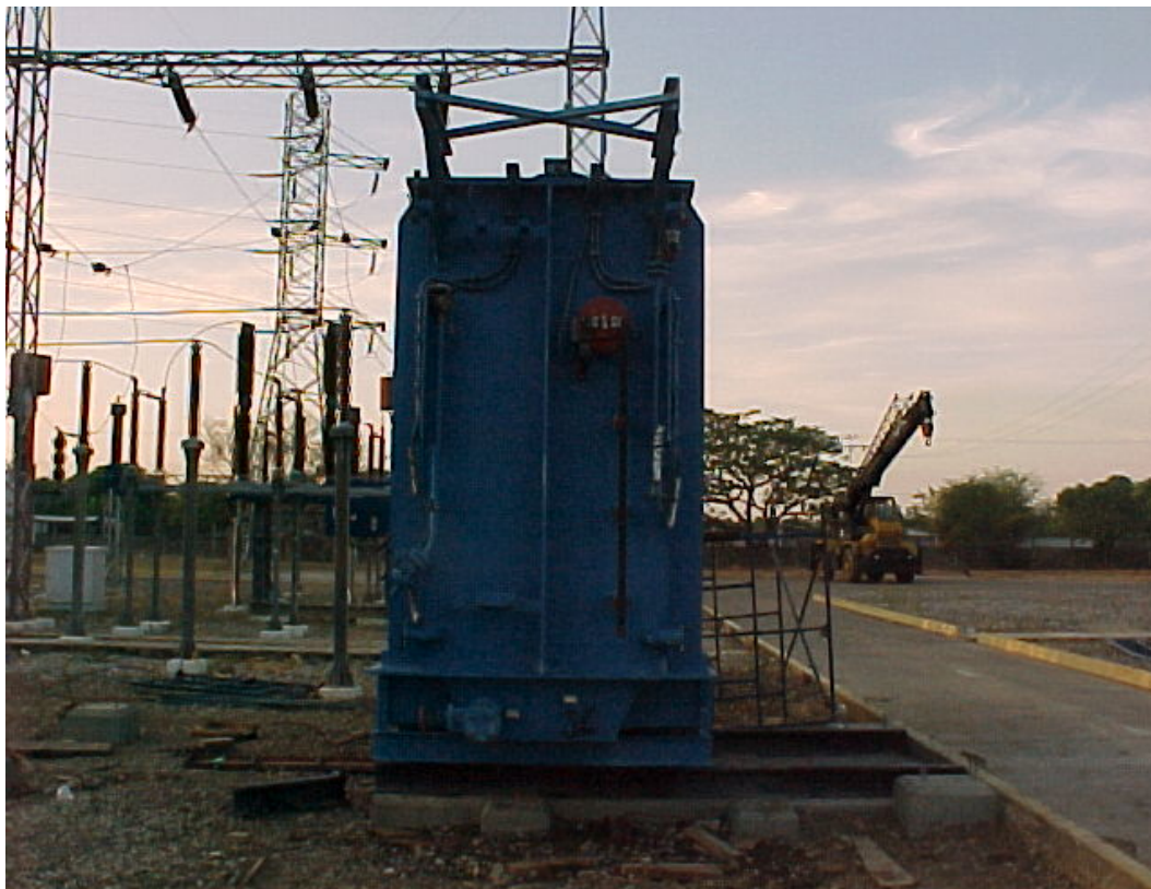
Figura 8.4, Base del transformador
