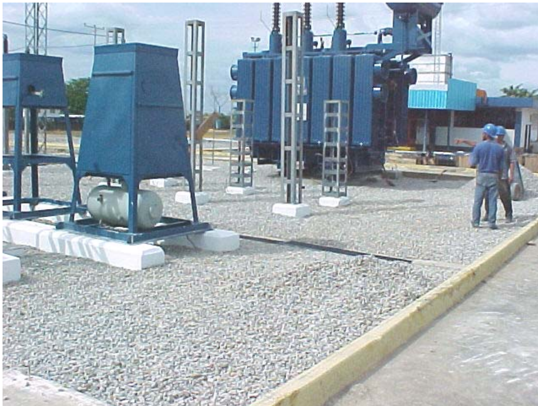
Figura 8.3, Patio del transformador y pararrayo
