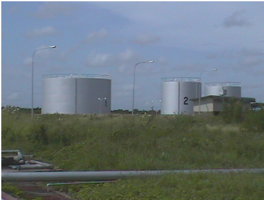
Figura 6.4, Tanques para almacenaje de combustible líquido (Planta Alfredo Salazar-Anaco)
