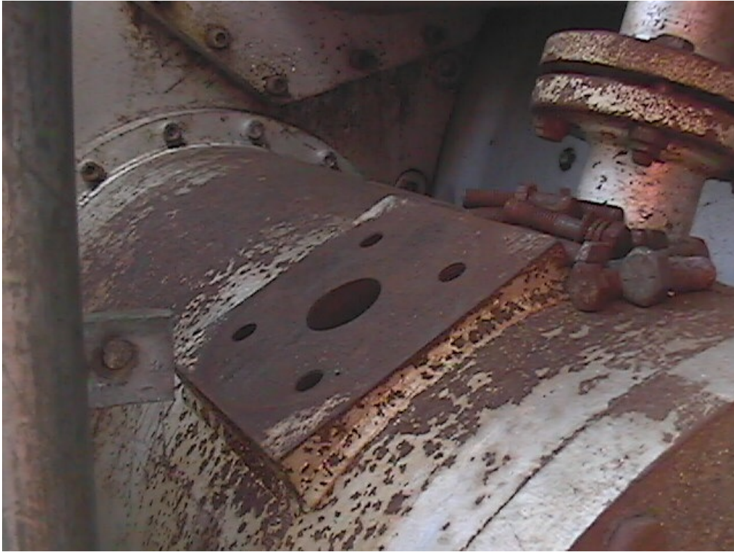
Figura 5.5, Falta bujía de encendido
