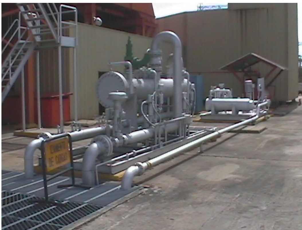
Figura 6.7, Skid de combustible para la unidad (Planta Alfredo Salazar-Anaco)
