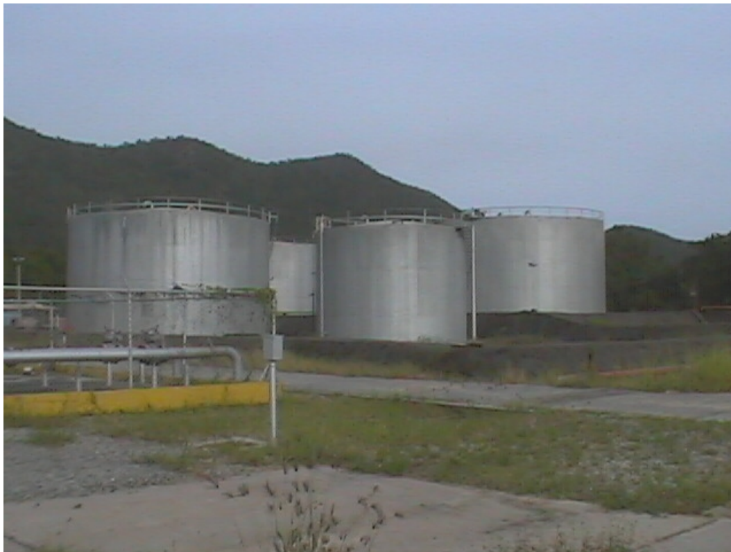
Figura 6.12, Tanques de combustible líquido de la planta (Planta Guanta-Guanta)
