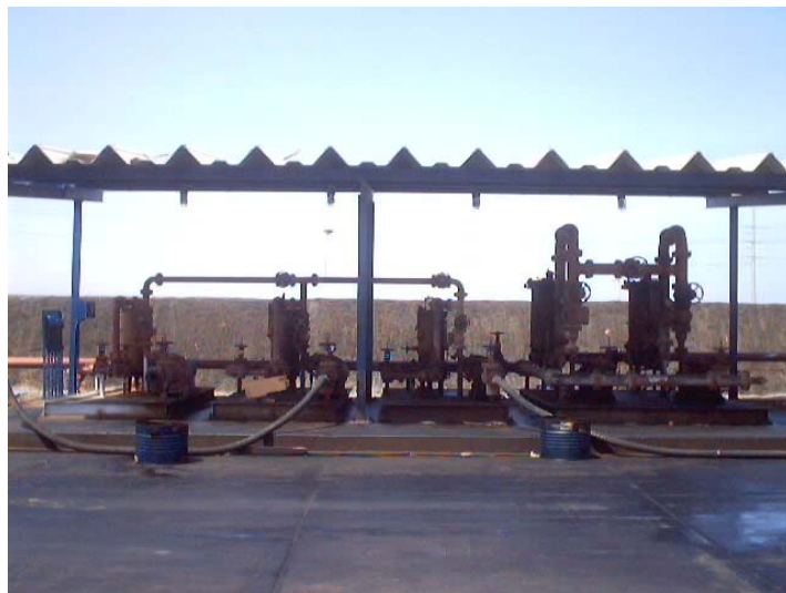
Ilustración 6.9 Sistema de distribución y bombeo de gasoil
