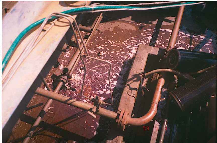
Ilustración 6.15 Fugas de gasoil (cambio de filtros)
