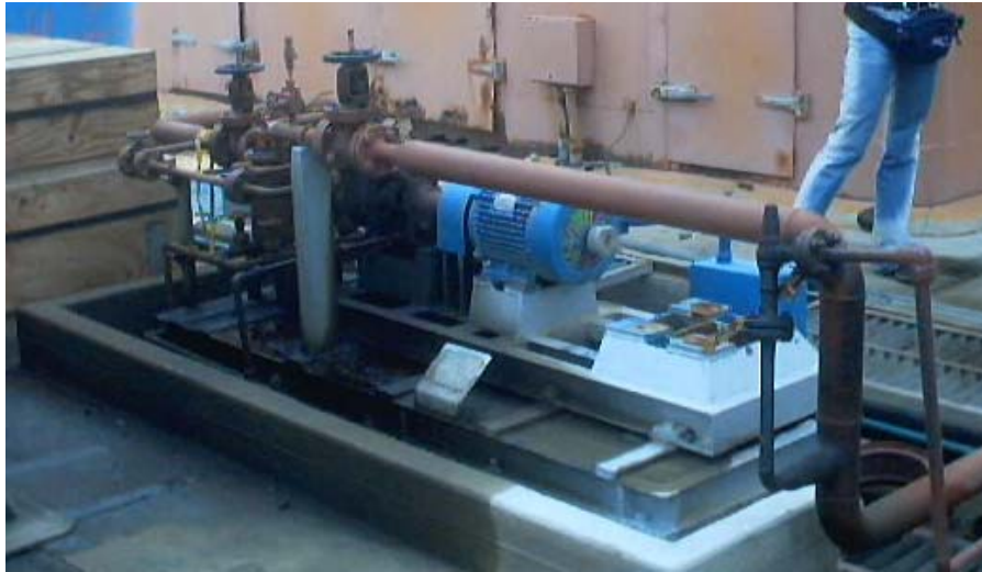
Ilustración 6.7 Fuel forwarding skid
