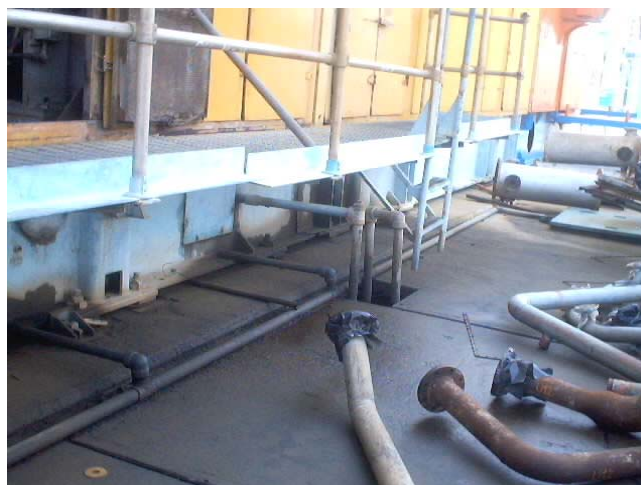
Ilustración 6.5 Drenaje de la unidad dirigido al sumidero
