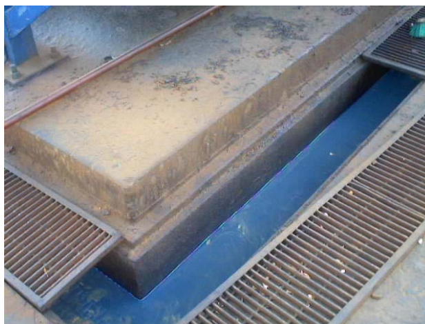
Ilustración 6.12 Tanquilla alrededor del sistema de distribución
