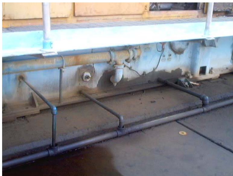
Ilustración 6.3 Drenaje de la unidad (dirigida al sumidero)
