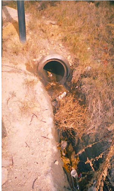
Ilustración 6.16 Tubería de aguas servidas
