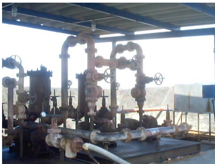
Ilustración 6.11 Sistema de distribución de combustible (2 turbas de llenado de tanque diario)
