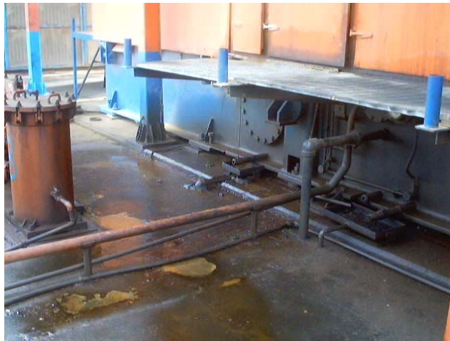
Ilustración 6.4 Bandejas en los drenajes de la unidad (recolección de fugas)
