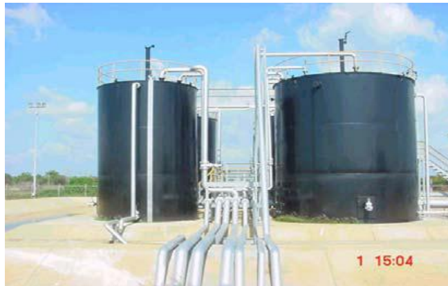
Figura 2.7 Tanques de Almacenamiento [3].
