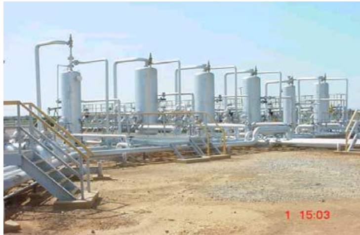
Figura 2.5 Separadores de Producción/Prueba [3].
