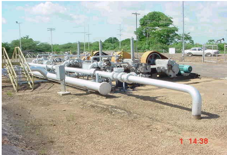
Figura 2.8 Bombas de Transferencia [3].
