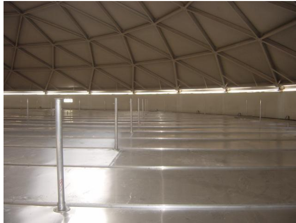
Figura 2.22. Tanque de techo flotante [3].
