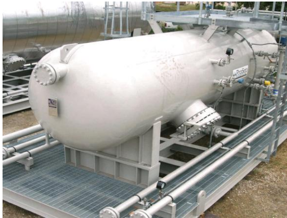
Figura 2.10 Separador horizontal bifásico [6]
