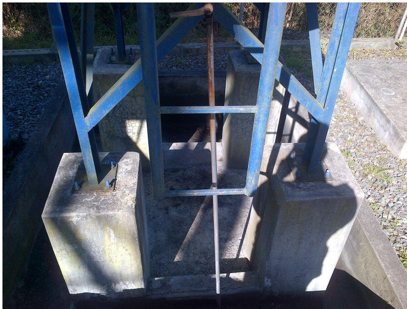
Figura 21. Bases de concreto que soportan el cisterna de 2795 litros.
