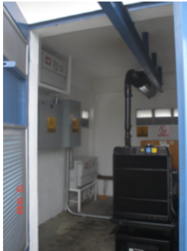
Figura 3. Transformador seco 220/110 de 5 kVA de potencia ubicado en la parte inferior, debajo de los tableros eléctricos.
