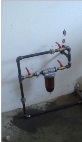
Figura 6. Trampa de agua para eliminar impurezas del diesel antes de llenar el tanque del motor generador.
