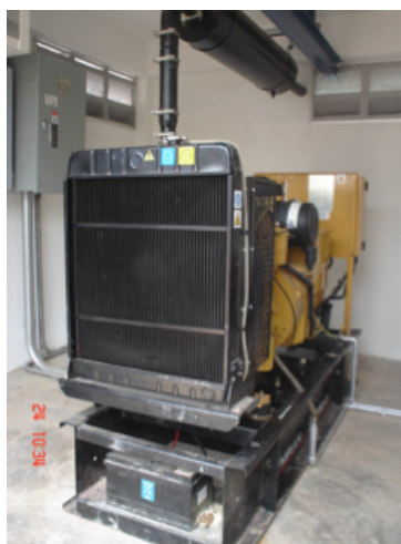
Figura 5. Tanque de combustible de 185 litros ubicado en la parte inferior del motor generador.
