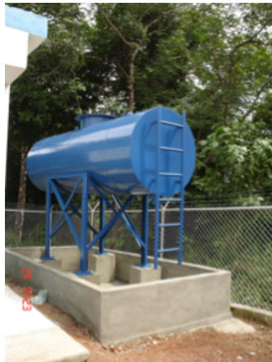
Figura 4. Cisterna de diesel de 2795 litros.
