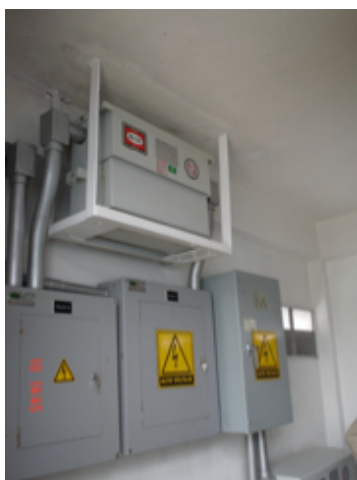
Figura 1. Transformador seco 440/220 de 30 kVA de potencia ubicado en la parte superior de los tableros eléctricos.
