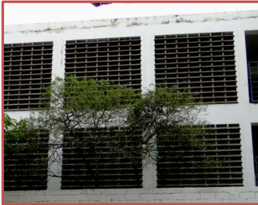
Figura No. 65. Grietas Verticales en la fachada Este 2011. (Diferencia de materiales). Grupo Escolar “Agustín Zamora Quintana”. Tomado de <<Fotos propias del autor>>.
