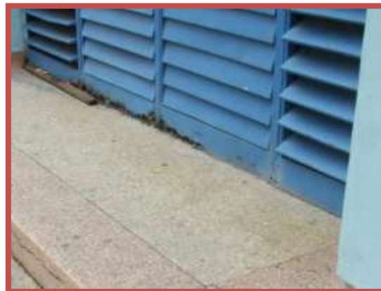
Figura No. 75. Corrosión presente en las puertas de hierro de romanilla del comedor, 2011. Grupo Escolar “Agustín Zamora Quintana”. Tomado de <<Fotos propias del autor>>.
