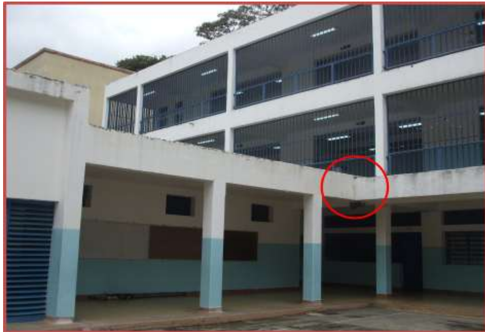
Figura No. 61. Ubicación de las grietas a 45° en vigas perimetrales de la planta baja 2011. Grupo Escolar “Agustín Zamora Quintana”. Tomado de <<Fotos propias del autor>>.
