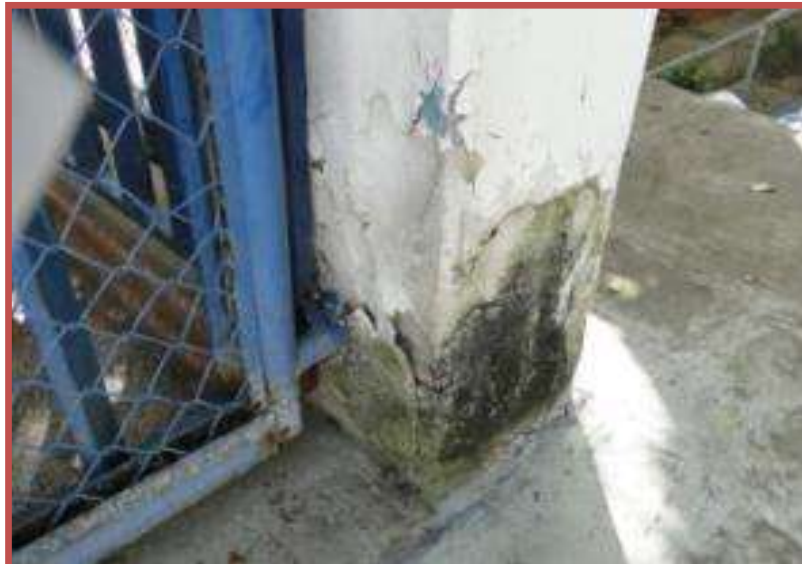
Figura No. 63. Desprendimiento del concreto en columna de la fachada Norte por causa de la humedad y corrosión del acero. 2011. Grupo Escolar “Agustín Zamora Quintana”. Tomado de <<Fotos propias del autor>>.
