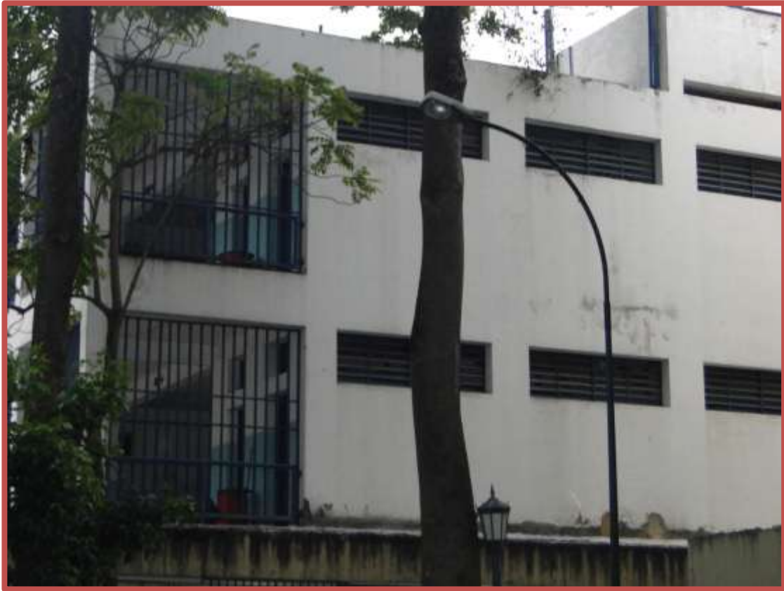
Figura No. 31. Vista de la fachada Oeste, 2011. Se observan el pasillo perimetral del ala Norte y las ventanas de los baños. Tomado de <<Fotos propias del autor>>.
