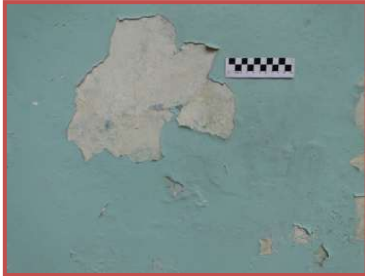
Figura No. 71. Exfoliación, abombamiento y desprendimiento presentes en el friso y pintura de las paredes exteriores (bloques de arcilla) del área de baños cercanos al comedor. 2011. Grupo Escolar "Agustín Zamora Quintana". Tomado de <<Fotos propias del autor>>.
