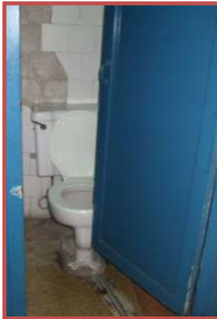
Figura No. 72. Faltantes de baldosas de cerámica por desprendimiento, 2011. Grupo Escolar “Agustín Zamora Quintana”. Tomado de <<Fotos propias del autor>>.
