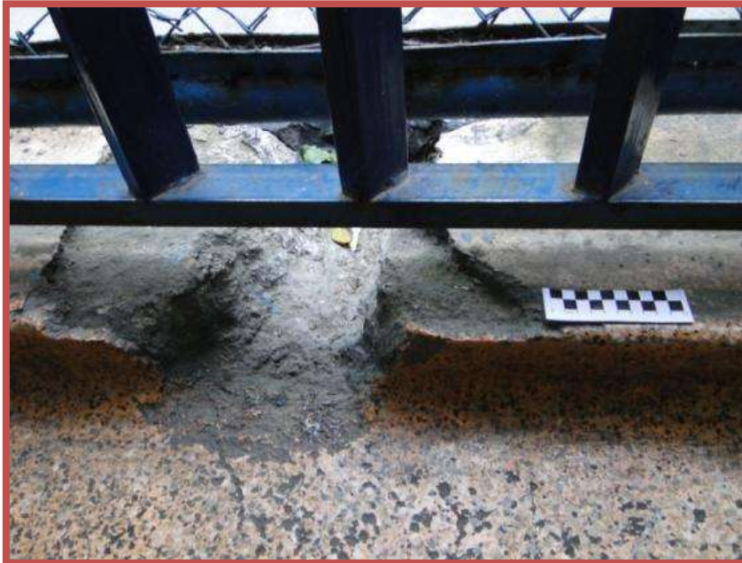
Figura No. 68. Drenajes improvisados en brocal de los pasillos, para desechar el agua después de limpiar los baños, 2011. Grupo Escolar “Agustín Zamora Quintana”. Tomado de <<Fotos propias del autor>>.
