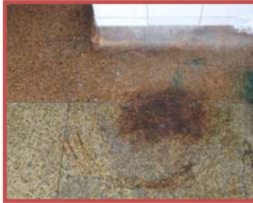
Figura No. 74. Manchas de óxido en el acabado de granito de los pisos en los accesos a los baños, 2011. Grupo Escolar “Agustín Zamora Quintana”. Tomado de <<Fotos propias del autor>>.
