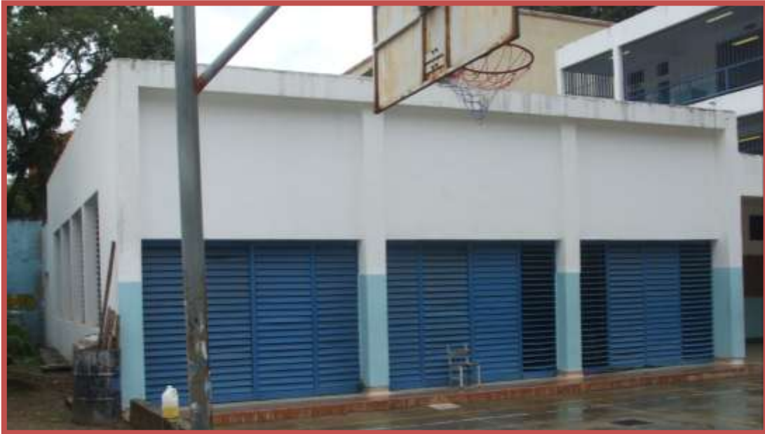
Figura No. 32. Vista de la fachada Este del comedor, 2011. Tomado de <<Fotos propias del autor>>.
