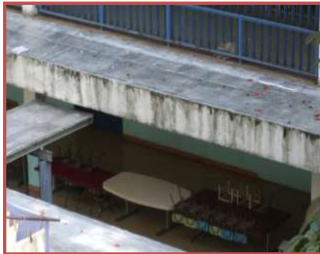
Figura No. 64. Lavado diferencial en la fachada Norte del Grupo Escolar, 2011. Grupo Escolar “Agustín Zamora Quintana”. Tomado de <<Fotos propias del autor>>.
