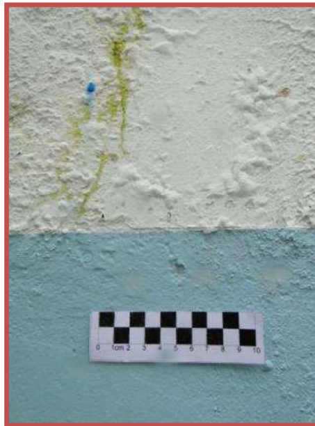
Figura No. 70. Eflorescencia y abombamiento presentes en el friso y pintura de las paredes exteriores (bloques de arcilla) del área de la cocina por causa de la humedad. 2011. Grupo Escolar “Agustín Zamora Quintana”. Tomado de <<Fotos propias del autor>>.
