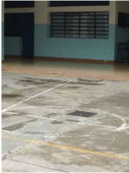
Figura No. 69. Desgaste del pavimento de concreto del patio, 2011. Grupo Escolar “Agustín Zamora Quintana”. Tomado de <<Fotos propias del autor>>.
