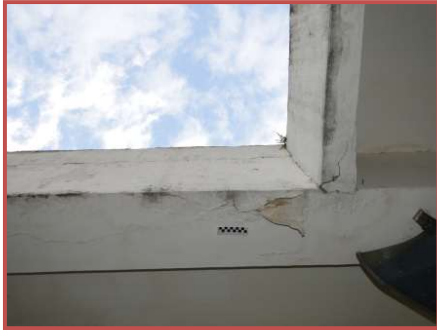
Figura No. 60. Grietas a 45° en vigas perimetrales de la planta baja 2011. Grupo Escolar “Agustín Zamora Quintana”. Tomado de <<Fotos propias del autor>>.
