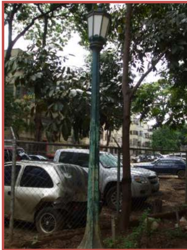
Figura No. 80. Faro de luz original del período de construcción de la Urbanización San Martín. (Todavía quedan unos pocos en pie), 2011. Grupo Escolar “Agustín Zamora Quintana”. Tomado de <<Fotos propias del autor>>.
