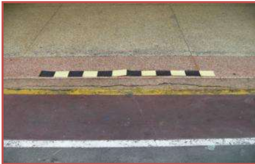
Figura No. 62. Grietas horizontales en la planta baja (asentamiento diferencial) 2011. Grupo Escolar “Agustín Zamora Quintana”. Tomado de <<Fotos propias del autor>>.
