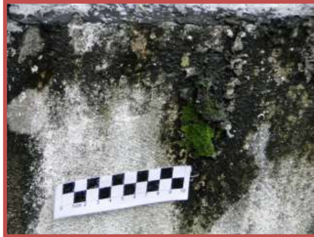
Figura No. 67. Presencia de pátina biológica en alero de la fachada Oeste (losa maciza de concreto), 2011. Grupo Escolar “Agustín Zamora Quintana”. Tomado de <<Fotos propias del autor>>.
