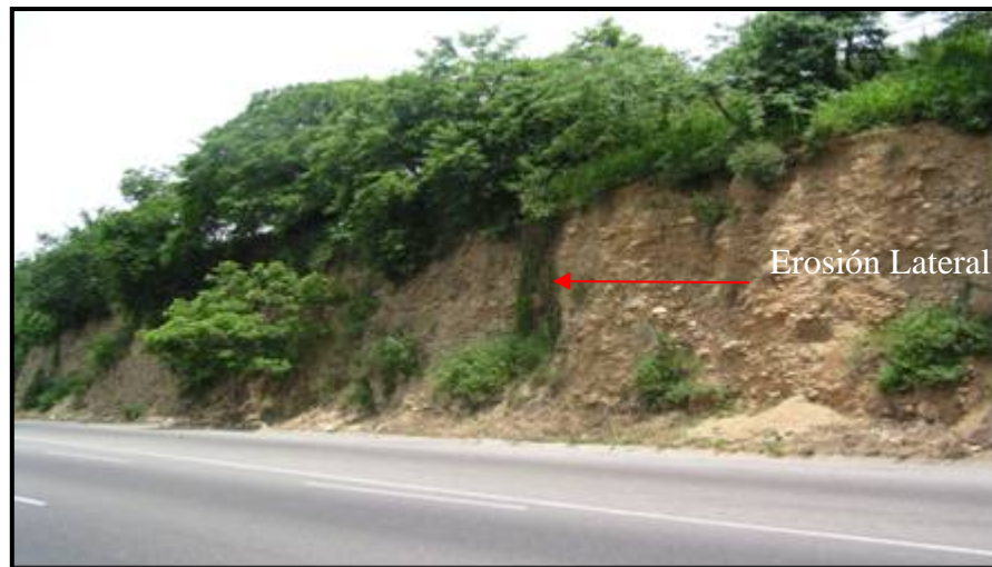
Fig. 26: Caída de bloques y generación de cárcavas producto de la erosión hídrica y fallas en obras de canalización (talud T17 – 2 – 24).
