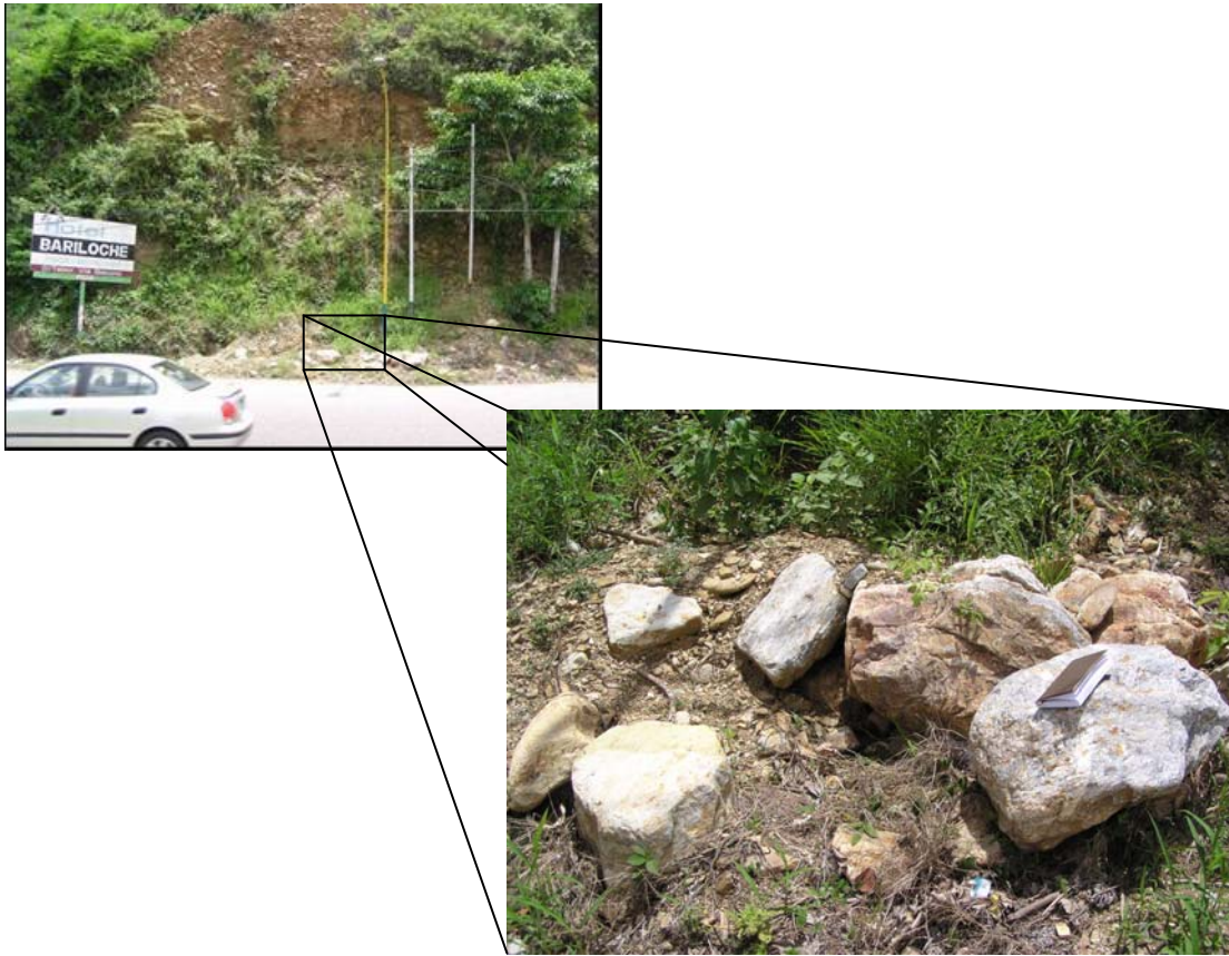
Fig.22: Proceso de caída de bloques pertenecientes al talud T1 -2-1, con cantos encontrados dentro del material desplazado hacia la vialidad, diámetro de hasta 45 cm.
