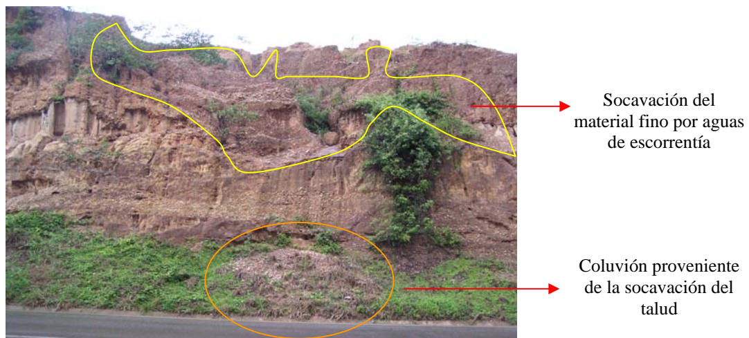
Fig. 43: Proceso de socavación del nivel conglomerático producto de la acción de las aguas de escorrentía, en la base del talud se encuentra material compactado naturalmente desplazado por los procesos (Talud T3-2-5).
