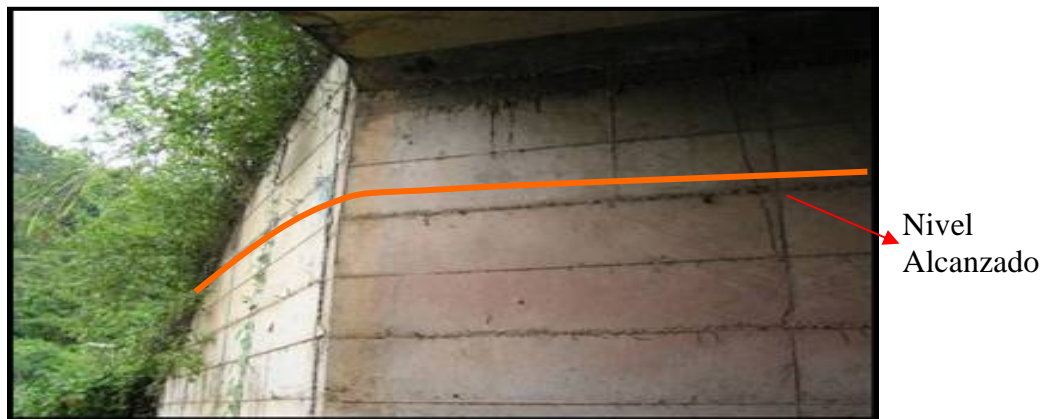
Fig. 19: Marca de evento de inundación fluvial, de hasta 5m de altura sobre las bases de un puente en el eje vial, situado en las adyacencias de la unidad de trabajo L3-2-25.
