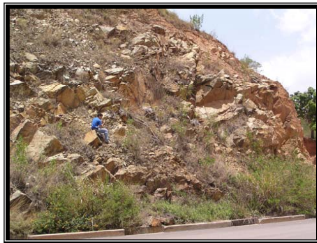
Fig 15: Caída de rocas en Unidad de Mármol
