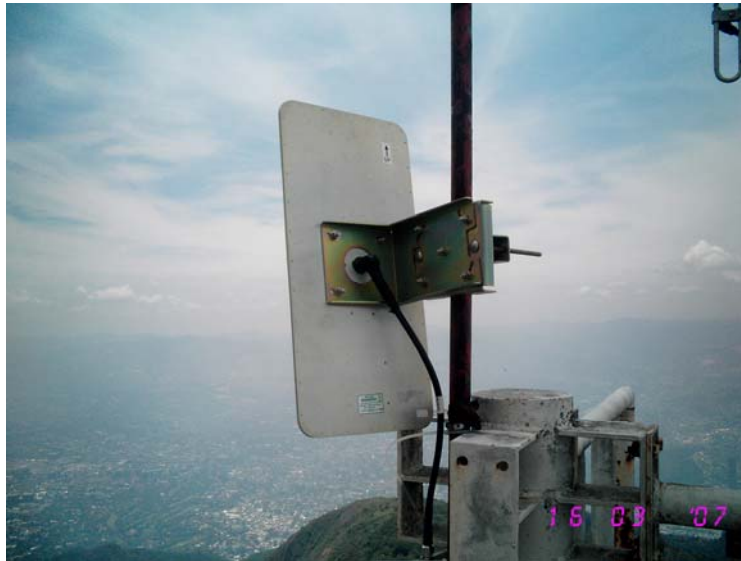
Antena Base apuntando hacia el Este de Caracas
