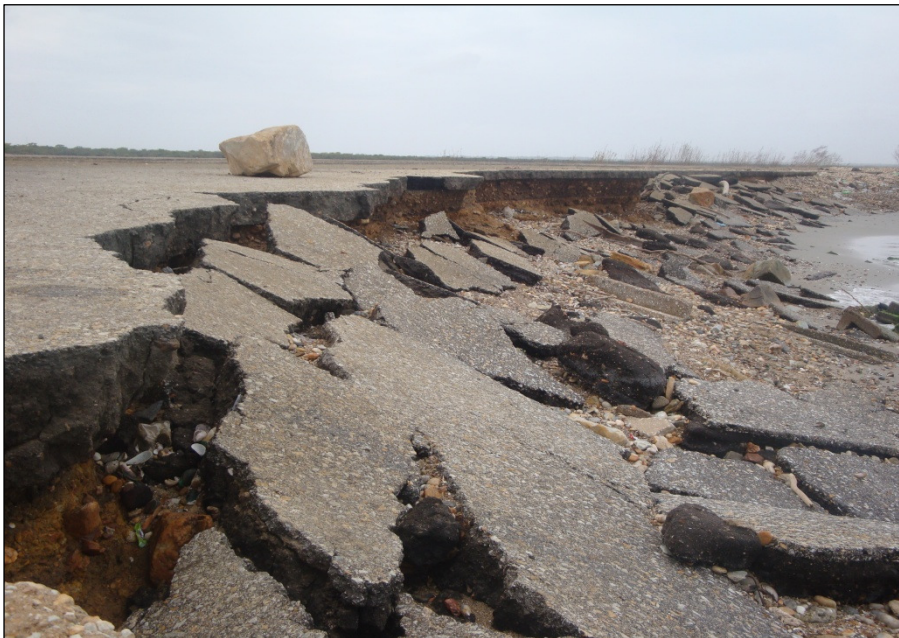
Fotos N° 9 y 10. Erosión Costera en el Sector El Palotal al suroeste dentro del área de estudio.
