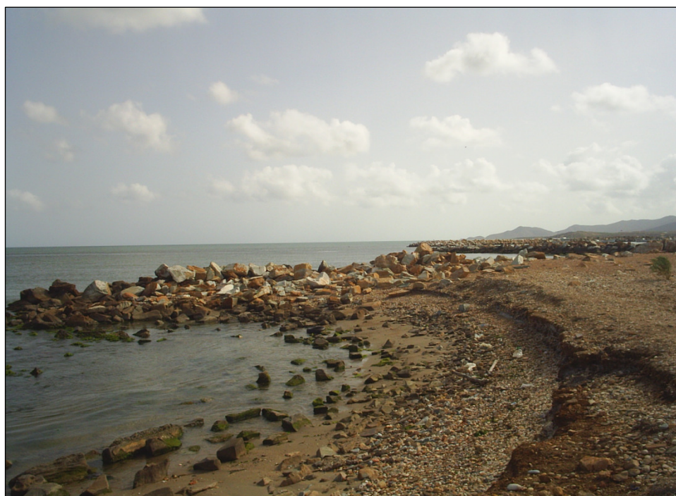
Fotografía N° 11. Espigón deteriorado por los efectos del oleaje.
