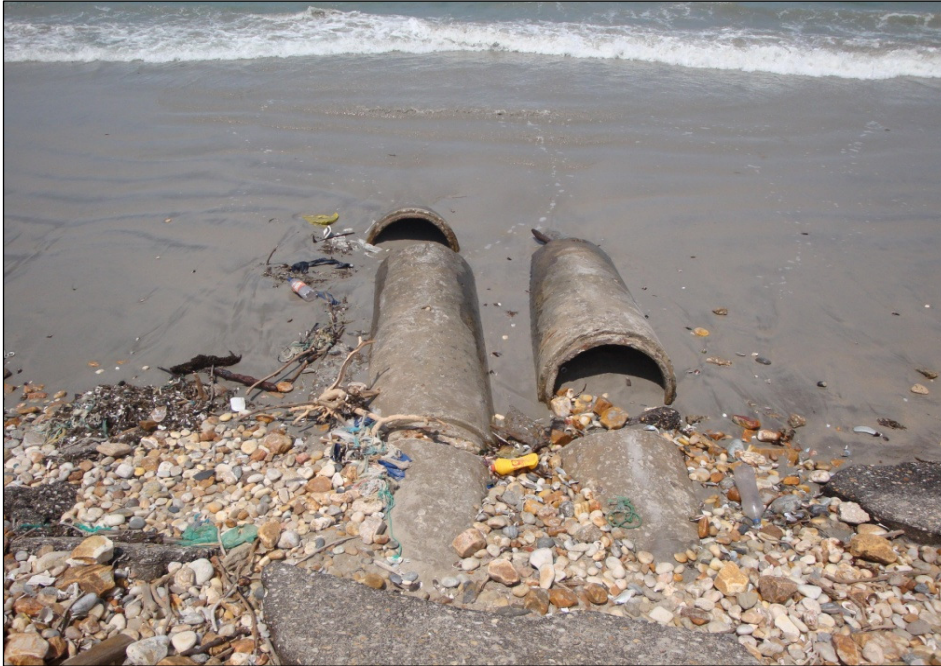
Fotografía N° 14. Obras de drenaje completamente obstruidas
