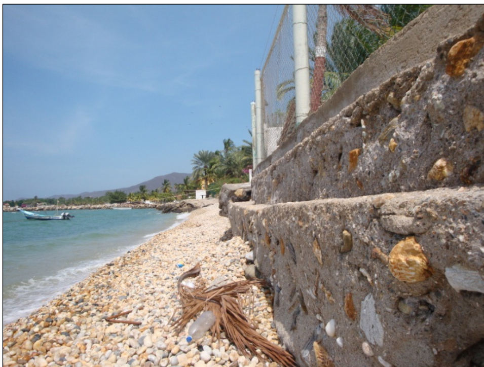
Fotografía N° 15. Construcciones cercanas a la costa
