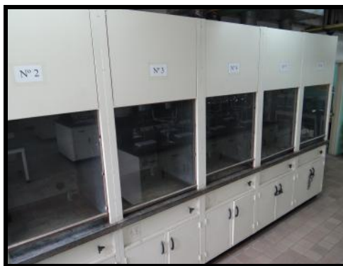
Fotografía correspondiente a gabinetes inferiores de las campanas de extracción para almacenar reactivos líquidos en el Laboratorio de Análisis Químico Cuantitativo
