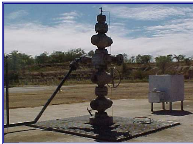
Figura 14. Cabezal de pozo
