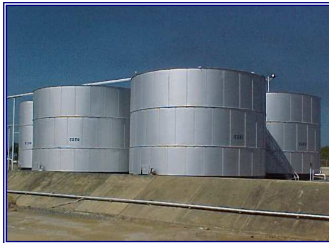
Figura 21. Tanques de almacenamiento
