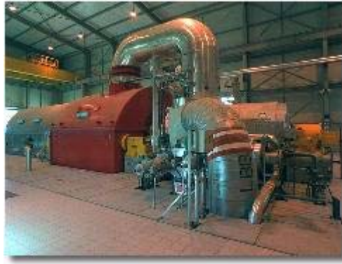
Turbina a Vapor Figura 4.16.
