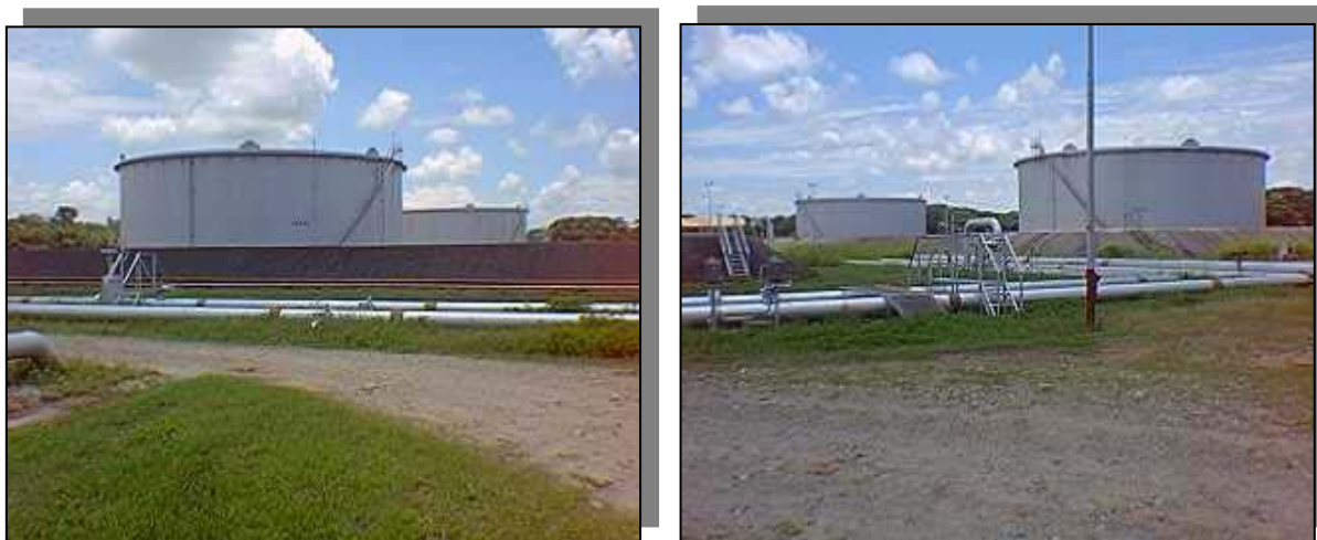
Figura 2.6. Fotos de Tanques de Almacenamiento en la Estación Mayor.
