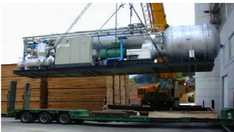
Figura 5.10. Entrega de ciclo ORC. Mano izquierda evaporador, mano derecha regenerador, centro adelante turbina (blanca) y generador (verde), centro atrás condensador.
