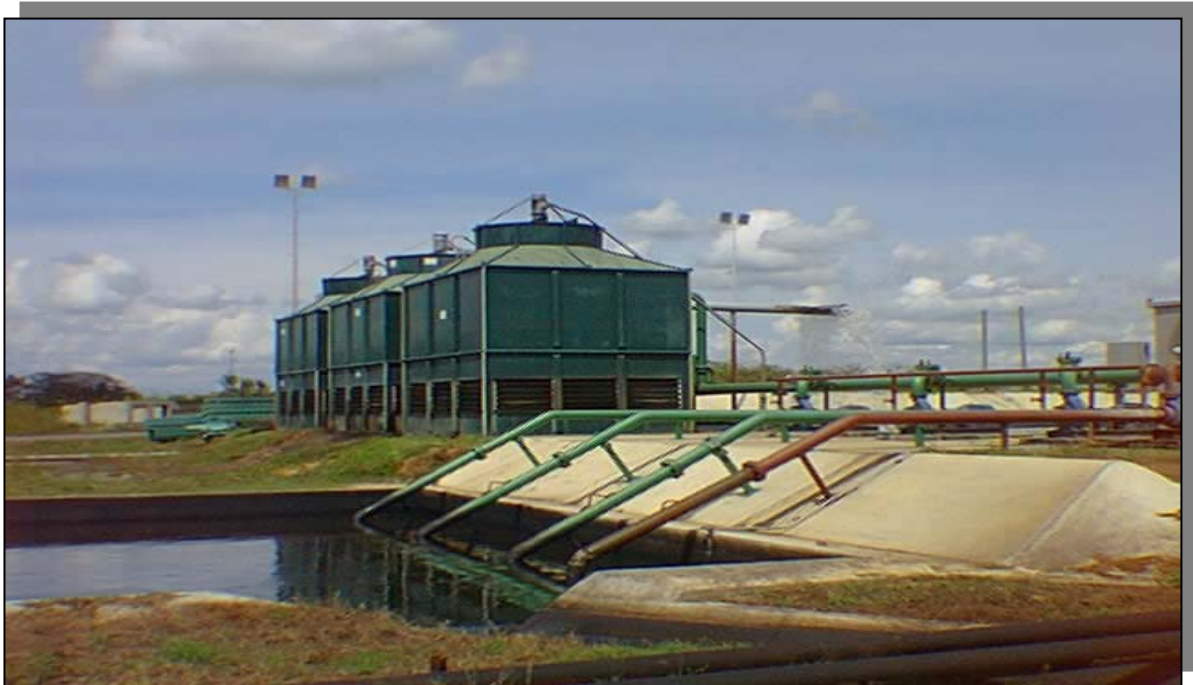
Figura 2.7. Fotos de Torres de Enfriamiento.
