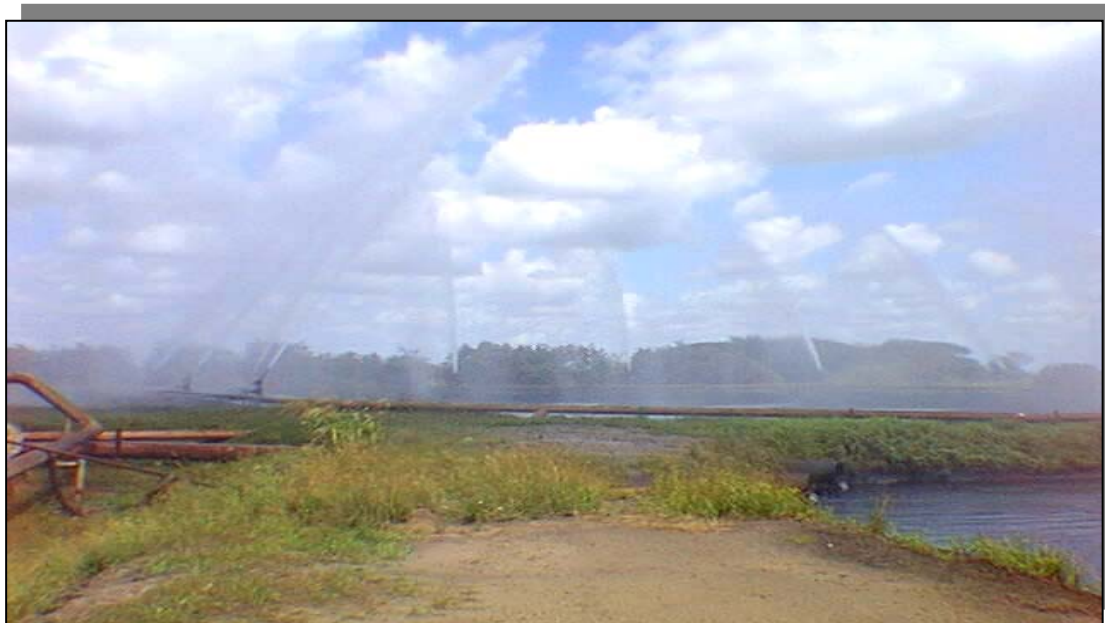
Figura 2.8. Sistema de Aspersores en las Lagunas de Enfriamiento.
