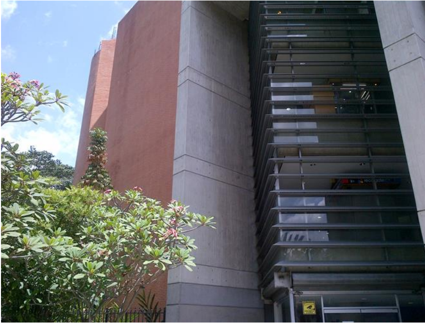
Foto 16, chorreo en fachada
