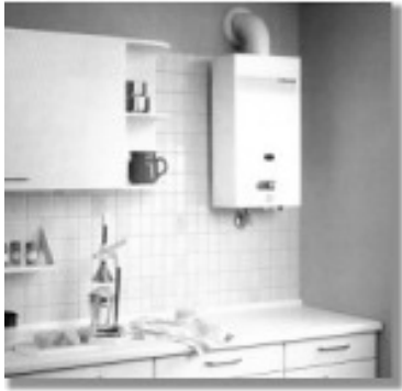
Foto N° 5 Instalaciones y equipos a gas para calentar agua
