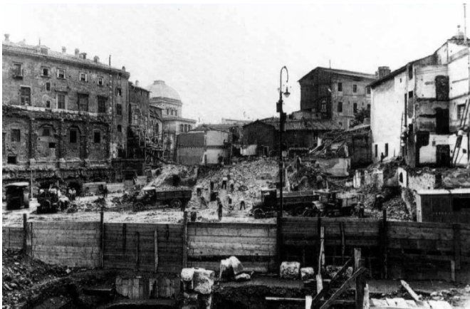
Vista de los trabajos de demolición para dejar al descubierto "Il Teatro di Marcello" (el cual se puede observar a la izquierda) y crear la vía para valorizar su imponente fachada como ícono de la antigua Roma.
