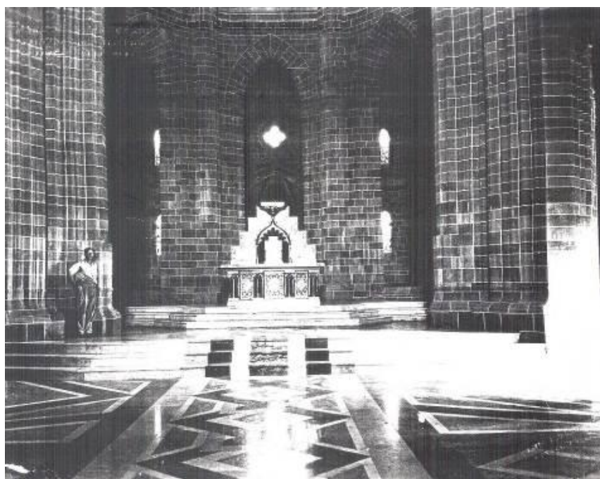
Figura 3.80: Trabajos finales de la colocación del piso de mármol. (Fuente: Anón., s.f. [1939 c.], en Archivo Siervas del Santísimo Sacramento).
