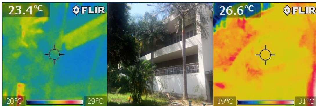
Figura 48. Imágen termográfica de la fachada sur del Edificio de Aulas Luis Damiani (a la izquierda la captura de la mañana y a la derecha la captura de la tarde).
