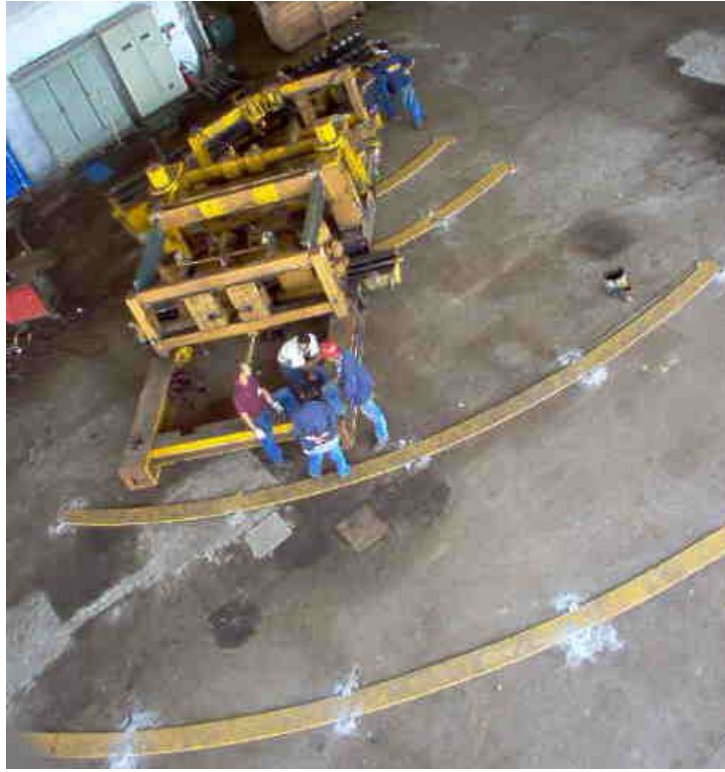
Figura 12 - Montaje de la Mesa de Conformación y de la Sección A del Bastidor de Entrada
