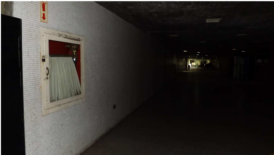
Fotografía 4-3 Gabinete de manguera. PB – pasillo de las anfiteátricas del conjunto de la FAU Autor: Yoisy Rangel, 2015
