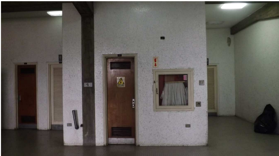
Fotografía 4-7 Gabinete de manguera. Piso 8 de la torre de aulas de la FAU Autor: Yoisy Rangel, 2015
