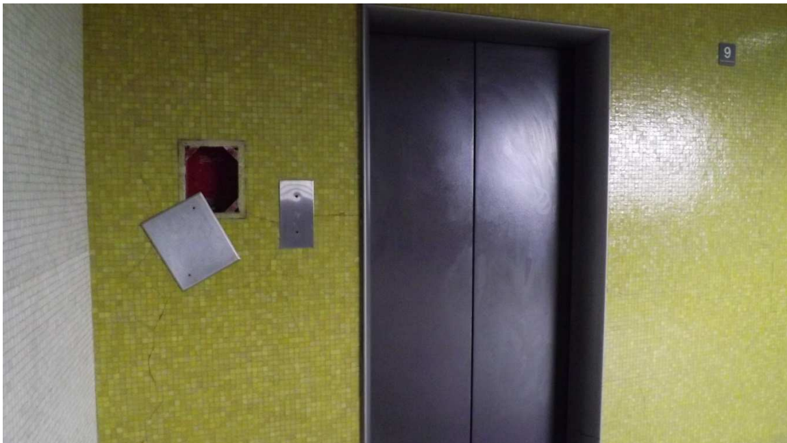
Fotografía 4-6 Cajetín para estaciones manuales de alarma. Piso 9 de la torre de aulas de la FAU Autor: Yoisy Rangel, 2015
