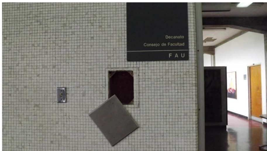
Fotografía 4-2 Cajetín para estación manual de alarma. Piso 8, Decanato de la FAU Autor: Yoisy Rangel, 2015
