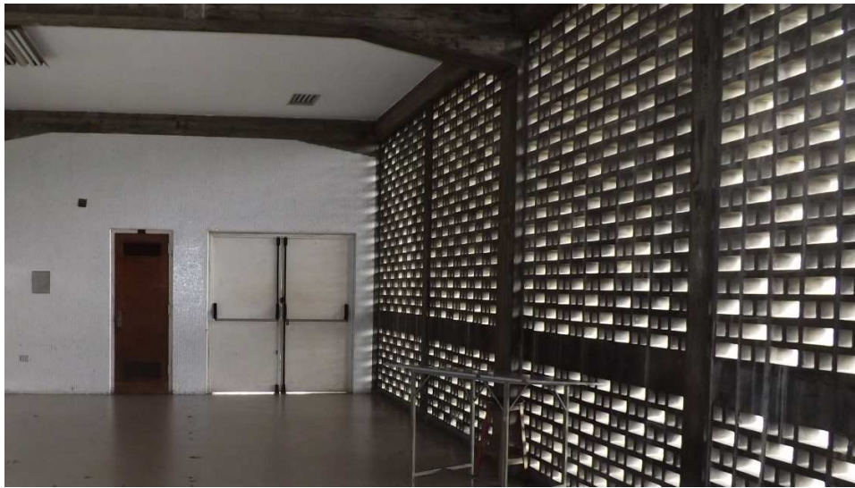
Fotografía 4-5 Barras antipánico de la puerta de emergencia del piso 7 de la torre de aulas de la FAU Autor: Yoisy Rangel, 2015
