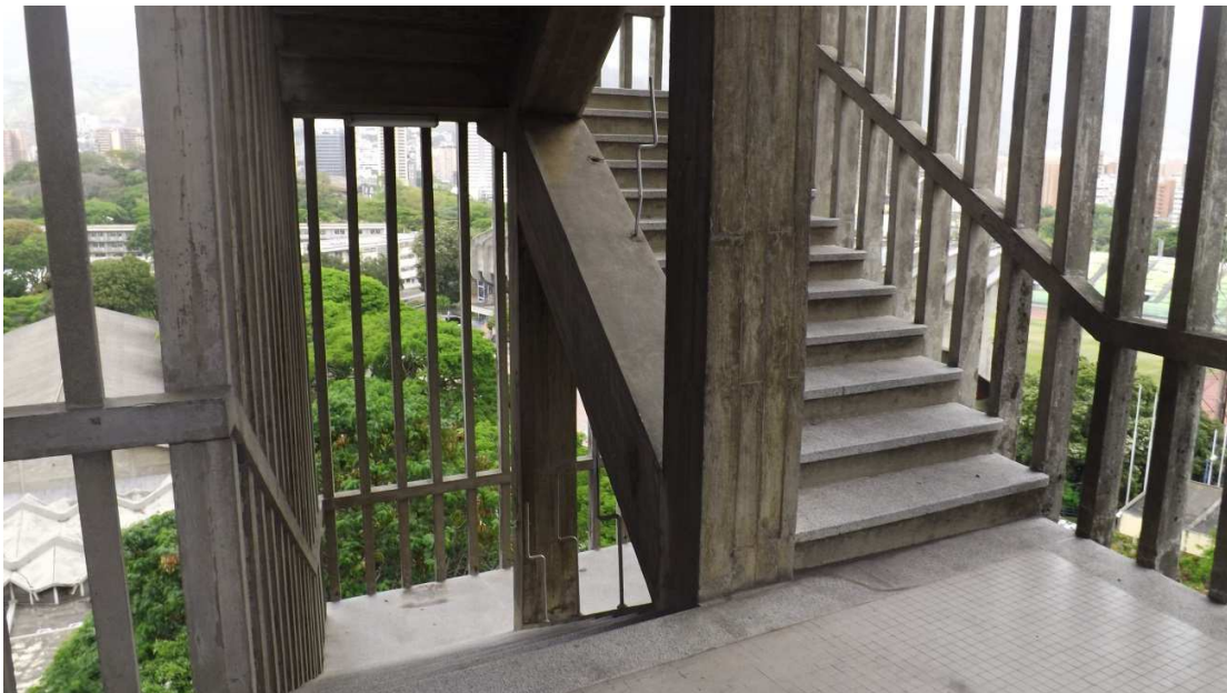
Fotografía 4-1 Escalera de emergencia, elementos verticales expuestos. Piso 6 de la torre de aulas del conjunto de la FAU Autor: Yoisy Rangel, 2015
