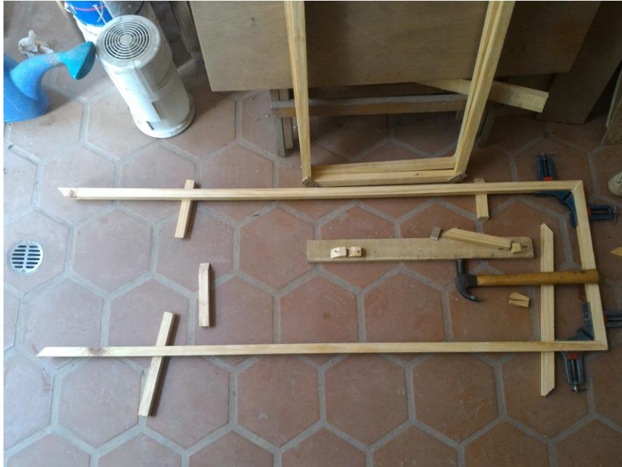
Figura 5.28: En la foto se muestra la forma en la que fue armado cada marco los mismos tienen un ángulo de 90 grados en cada esquina y su forma es rectangular, para garantizar que mantuvieran esta forma se uso pega y clavos.
