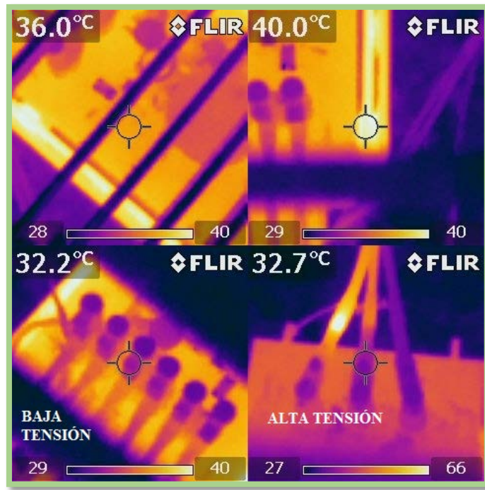
Figura N° 41. Termogramas transformador 2, 300kVA, Sótano ST-12.
