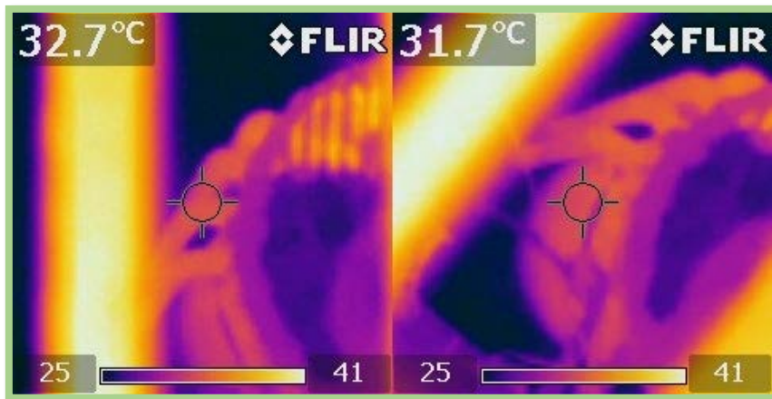
Figura N° 54. Termogramas transformador 75kVA, Sótano ST-15.
