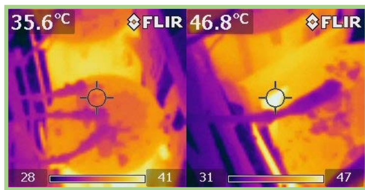
Figura N° 48. Termogramas transformador 3, 167kVA. Sótano ST-4.
