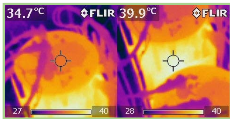
Figura N° 47. Termogramas transformador 2, 167kVA. Sótano ST-4.
