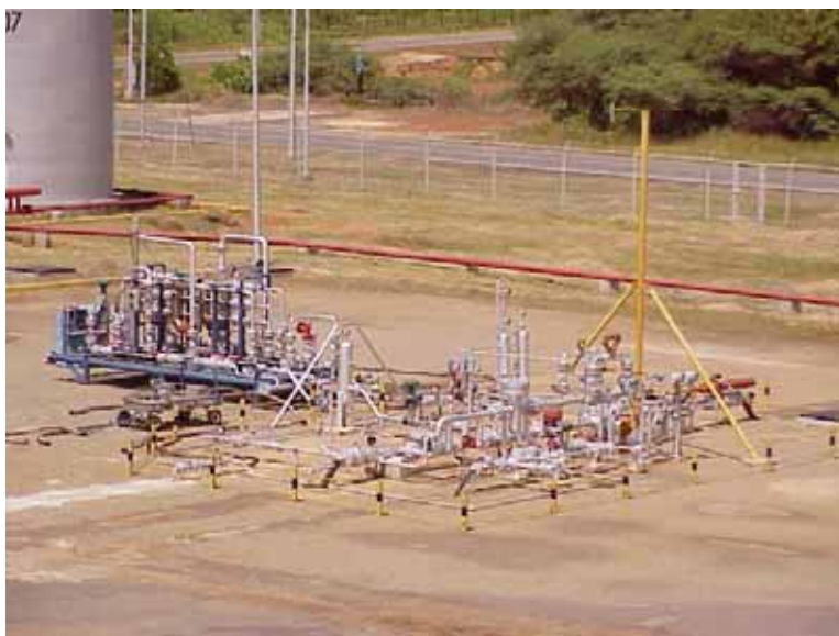
Fig. 23 Estación de gas
