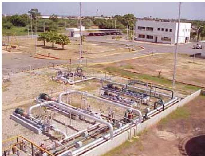
Fig. 26 Sistema de bombeo de crudo y agua
