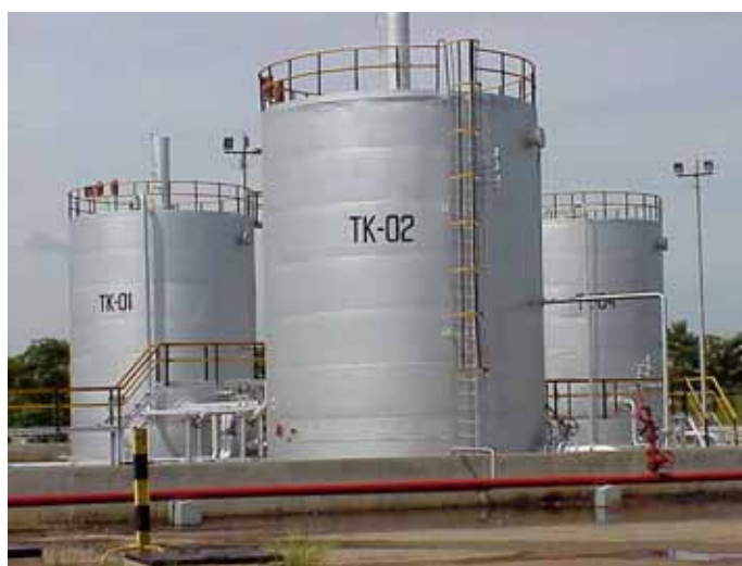
Fig. 27 Instrumentación de tanques
