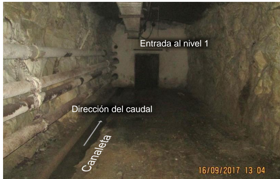
Figura 5.11. Canaleta en la galería principal de la entrada del nivel 1. Fuente: Elaboración propia.
