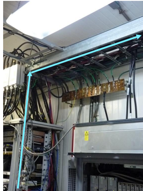
Recorrido 2 Cableado para el Tráfico
