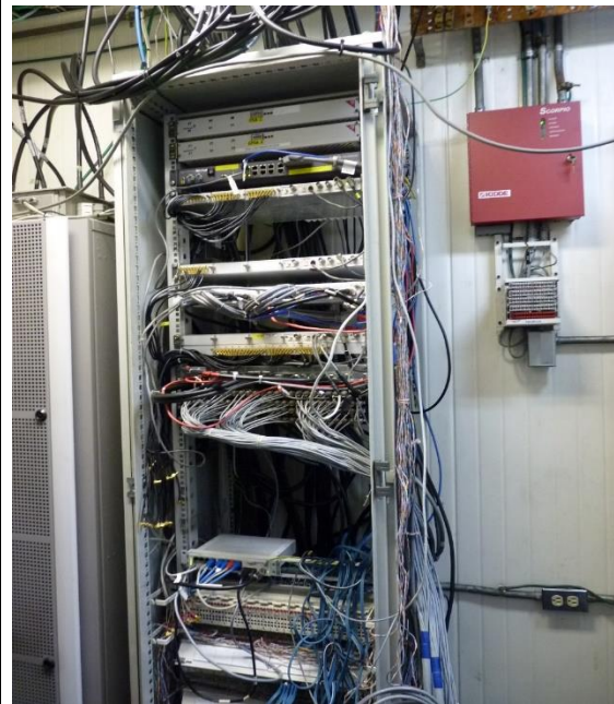
Vista del Rack N-2 En donde será instalado el Switch Corporativo
