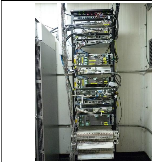
Rack-3 Equipos de Acceso
