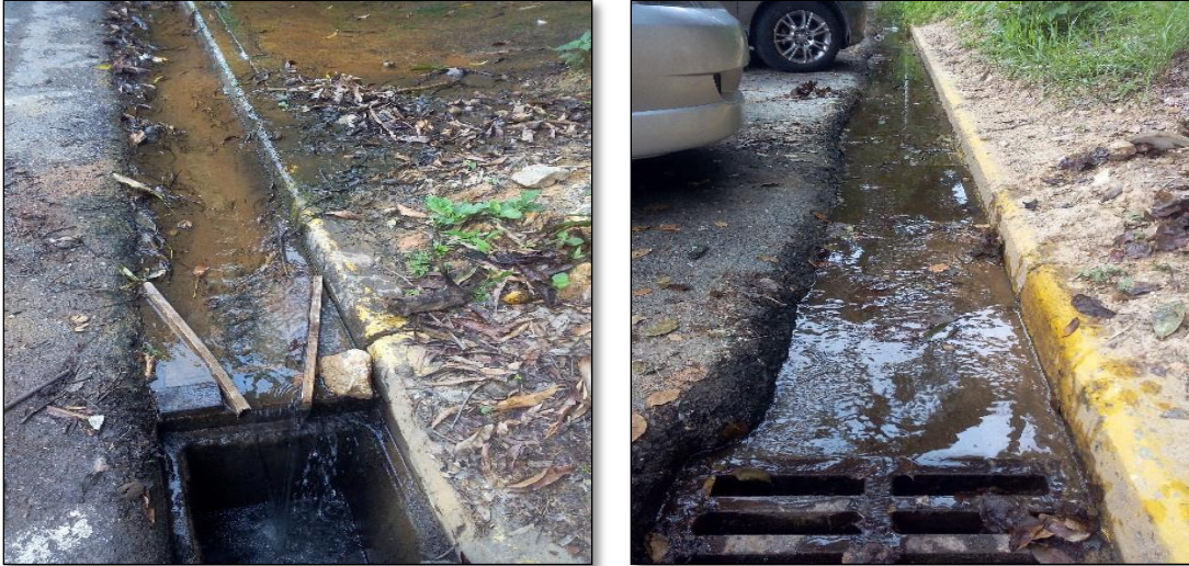
Figura 14. Lado izquierdo: Fuga de agua detectada en la entrada de la Escuela de Física. Lado derecho: fuga de agua en el estacionamiento este. Fuente: Elaboración propia.
