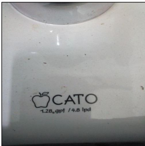
Figura N2. Caudal de descarga de las pocetas instaladas en las nuevas dependencias de la FC-UCV. Fuente: Elaboración propia.
