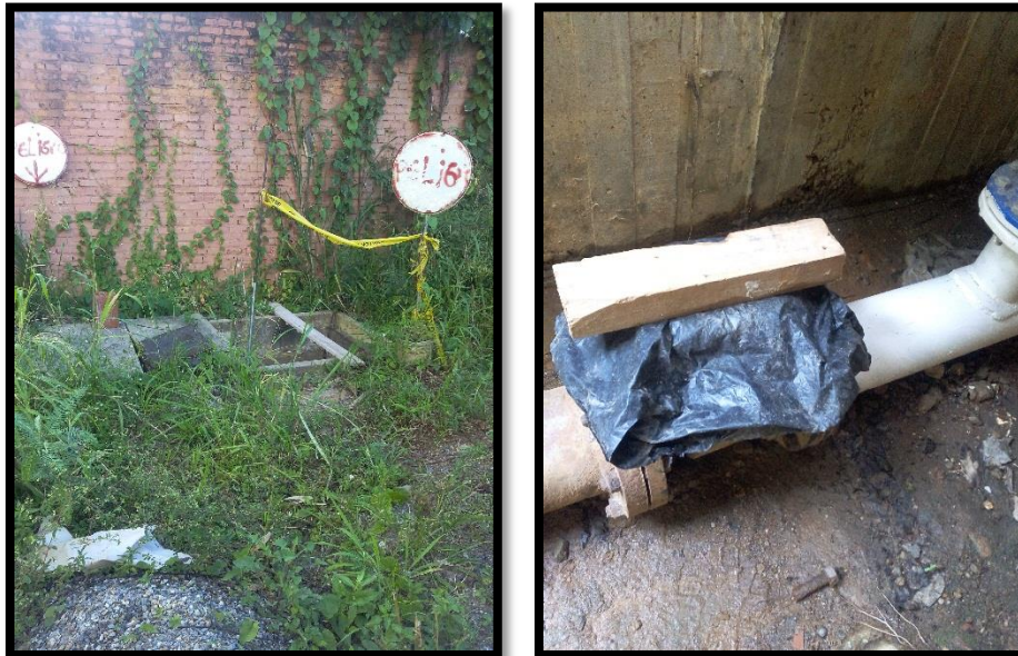
Figura B2. Condiciones actuales de la tanquilla donde se ubica el medidor de agua. Fuente: Elaboración propia.
