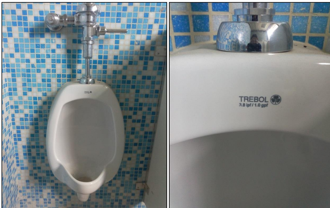
Figura N1. Urinarios instalados en las nuevas dependencias de la FC-UCV. Fuente: Elaboración propia.
