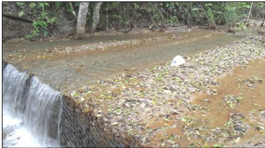
Figura 5. 29 Gavión colmatado de sedimentos, se observa la estructura firme. Fotografía tomada por José Cova.
