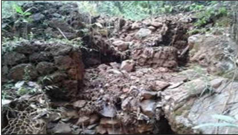
Figura 5. 28 Estructura colapsada por la fuerza de empuje. Fotografía tomada por José Cova.
